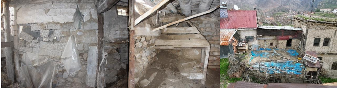
Resim 3.84. Z04 mahali eklenti pvc boru, ocak detayı ve toprak dam üzerinde bulunan çeşitli atıklar
