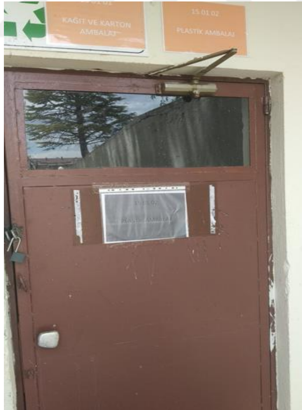
Fotoğraf 3.22. Otel 2'nin geçici atık depolama alanı 2 (2.geçici atık depolama alanı)
