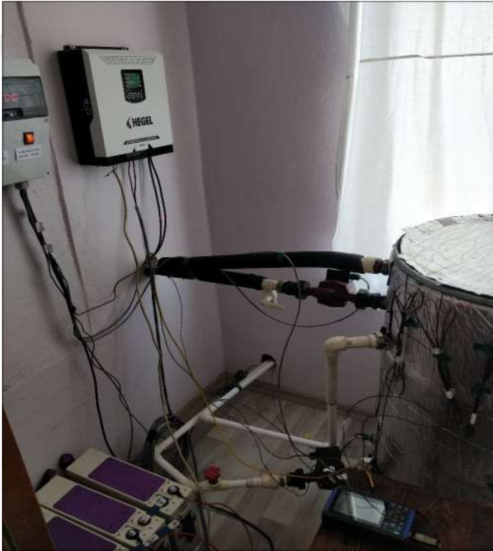
Şekil 4.18. Termastatlar, akıllı inverter, akü grubu, ısıl enerji tankı, pompalar, bilgi toplayıcı ve ısıçiftlerin görünümü
