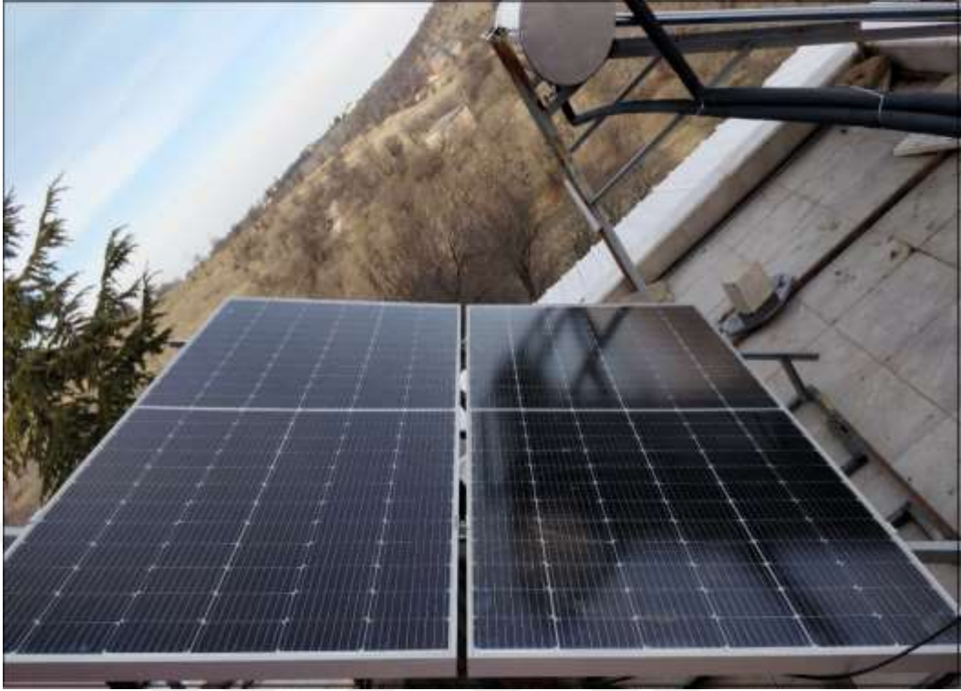
Şekil 4.12. Sistemde kullanılan fotovoltaik panelin görünümü
