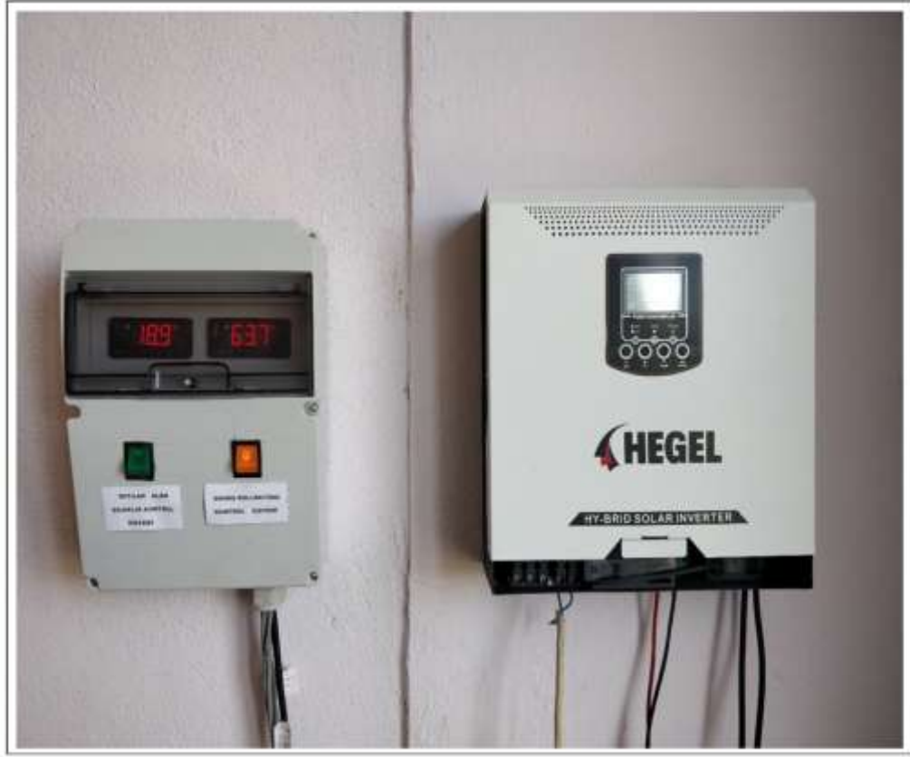
Şekil 4.27. Kontrol sisteminde dijital termostat ve akıllı inverter görünümü
