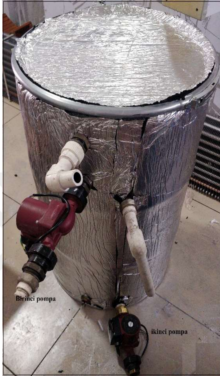
Şekil 4.8. Tasarlanmış sistemde kullanılan pompaların ısıl enerji tankında montaj sonrası konumları
