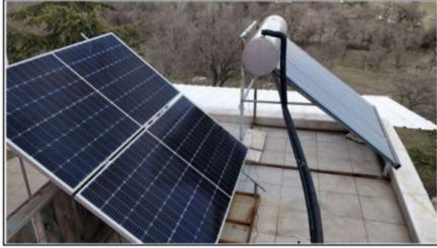
Şekil 4.25. Vakumlu güneş kollektörü ve fotovoltaik panel görünümü
