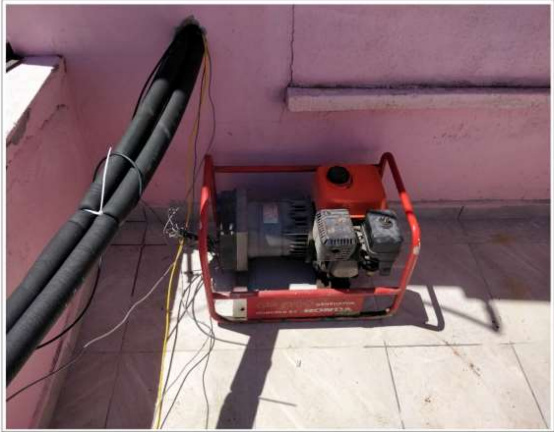
Şekil 4.20. Hibrit ısıtma sisteminde kullanılan jeneratörün görünümü
