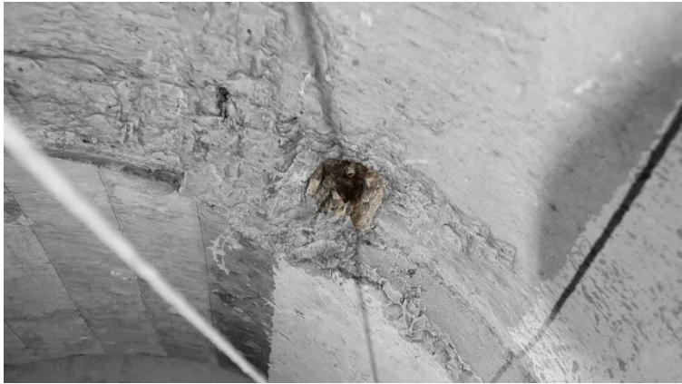
Şekil 4.21 : Etkin bir aktör: osmanlı bankası gümüş deposundaki Yarasa (Çatal, 2023)
