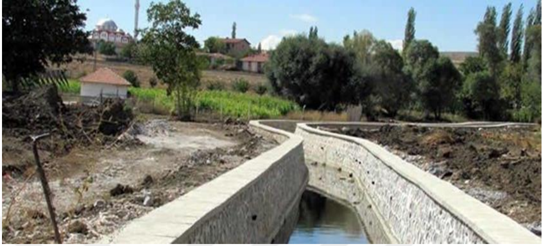
Resim 14. Duvarlı Taş Tahkimat Görüntüsü (Bartın)
