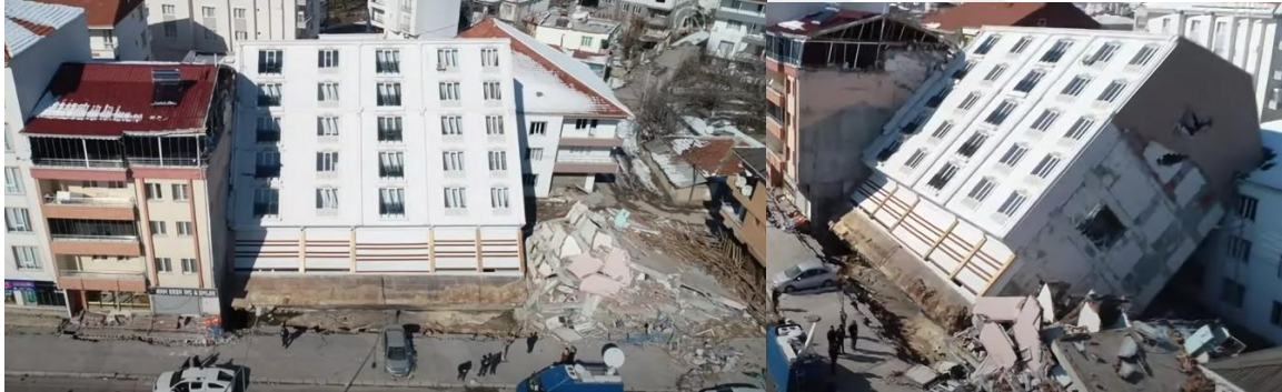
Resim 7.1. Kayı Apartmanı deprem sonrası hasar görünümü
