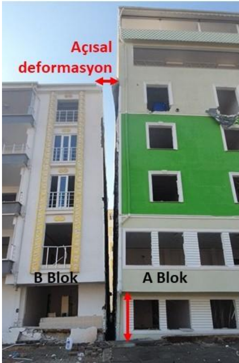
Resim 7.3. A ve B Blok sıvılaşma kaynaklı açısal deformaasyon görünümü
