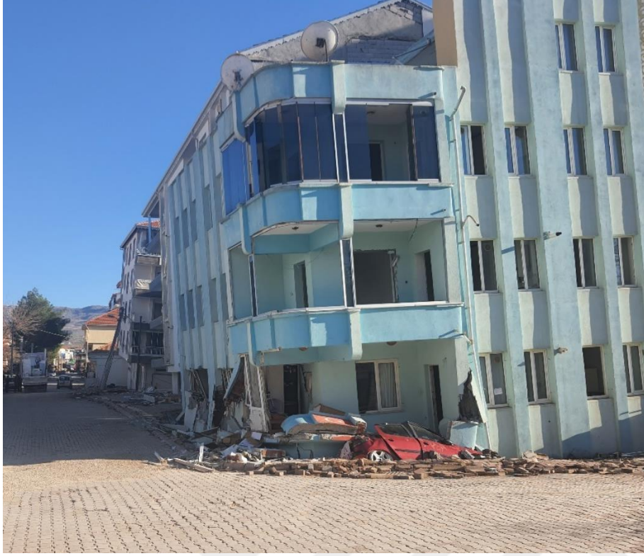
Resim 3.5. C blok yapı hasar görünümü
