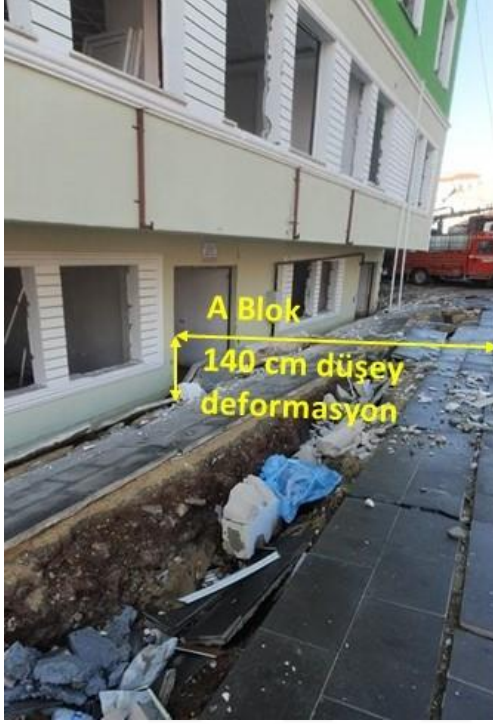
Resim 7.2. A Blok sıvılaşma kaynaklı düşey deformaasyon görünümü
