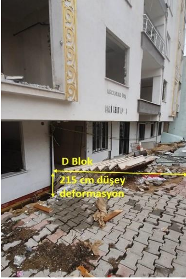
Resim 7.4. D Blok sıvılaşma kaynaklı düşey deformaasyon görünümü
