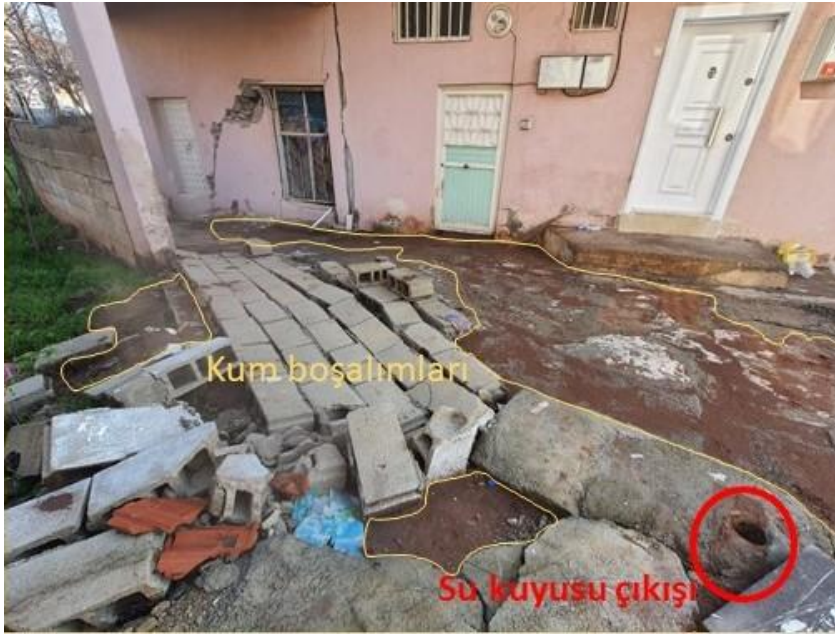
Resim 7.5. İnceleme alanı II'de gözlemlenen sıvılaşma kaynaklı kum boşalimleri
