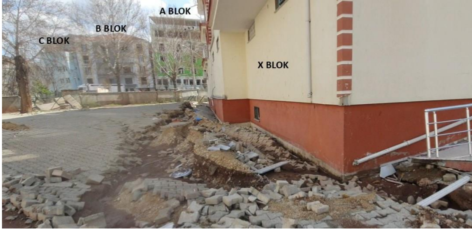
Resim 7.8. X blok deformasyonlarına ait bir görünüm
