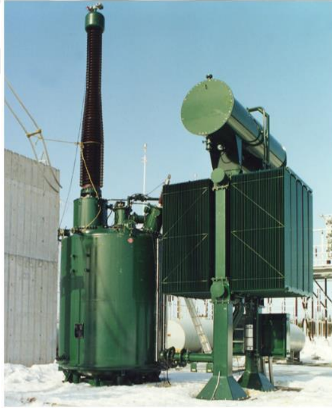
Şekil 3.4.Zorlanmış soğutma sistemi (GE Vernova Broşür)
