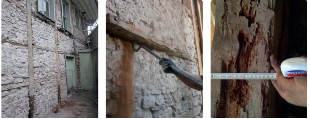
Şekil 4.6 Atmosfer olayları sonucu ahşapta oluşan bozulma (Tarihi Yapılar İçin Deprem Riskleri Yönetimi Kılavuzu, 2018).
