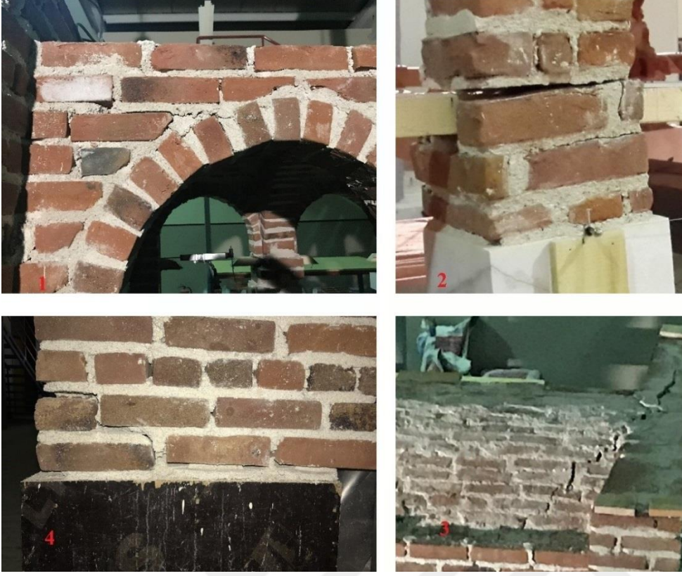
Şekil 6.39 Yapıda oluşan hasarların yakın görünümü.
