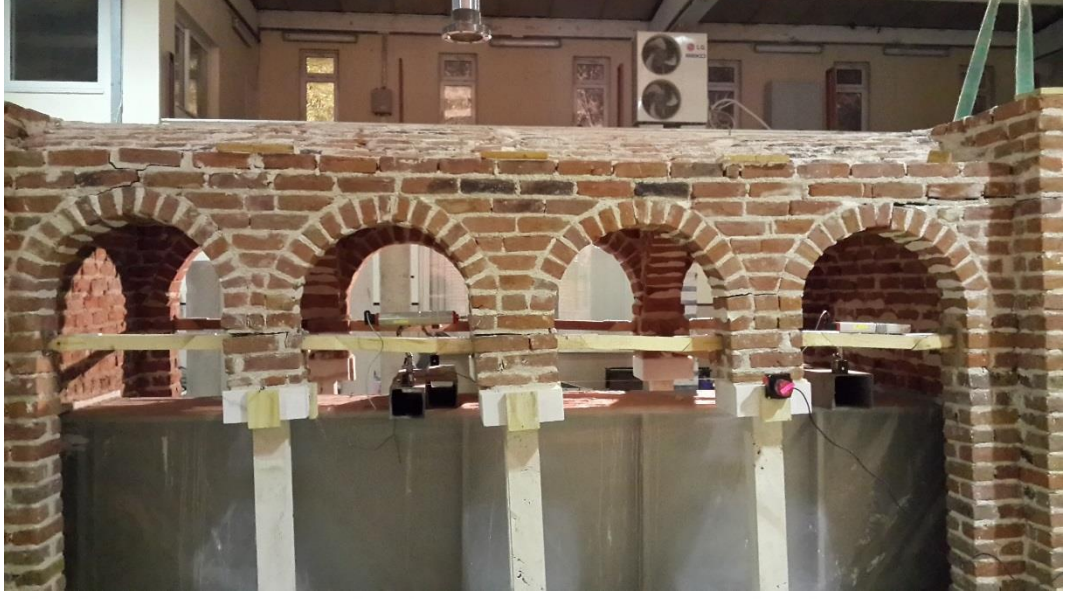
Şekil 6.45 Gergili sistemde meydana gelen çatlaklar ve sistemin yatay hareketi.
