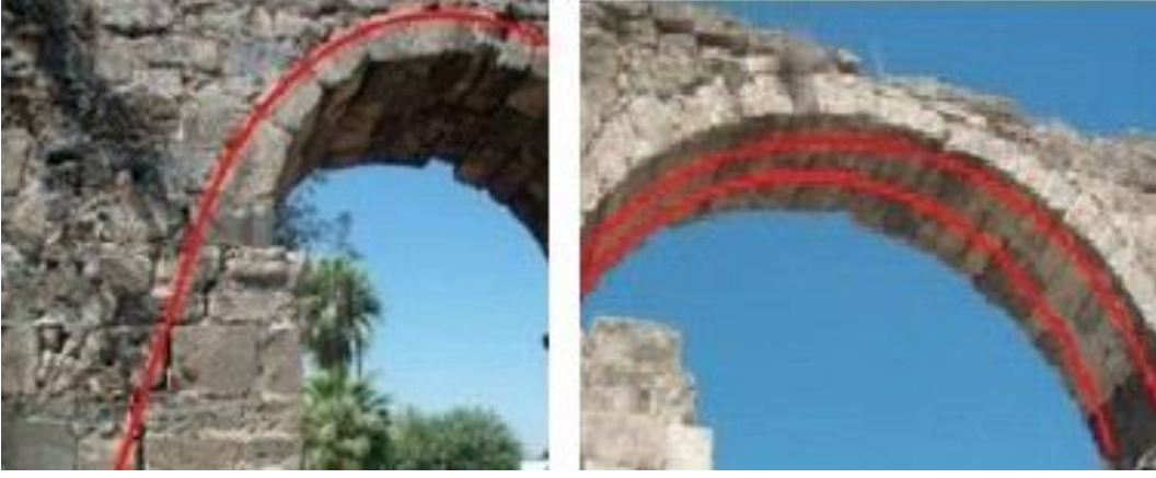
Şekil 4.9 Kemerde oluşan çatlaklar (Tarihi Yapılar İçin Deprem Riskleri Yönetimi Kılavuzu, 2018).
