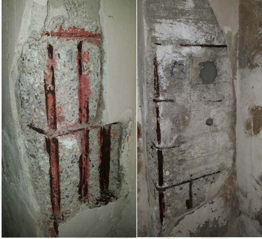
Şekil 2.1 : Donatı korozyonu hasarı.
