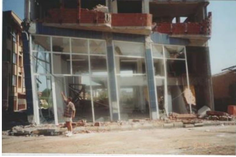
Şekil 1.6. Kocaeli depreminde yumuşak kat ve zayıf kat nedeniyle oluşan hasar [4]
