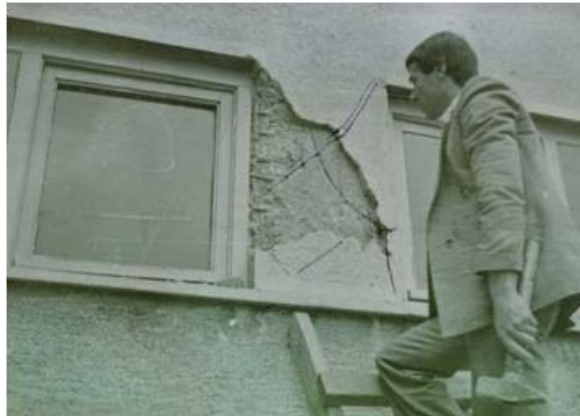
Şekil 2.7. Sık etriyeli kısa kolon örneęi (1992 Erzincan Depremi) [20]
