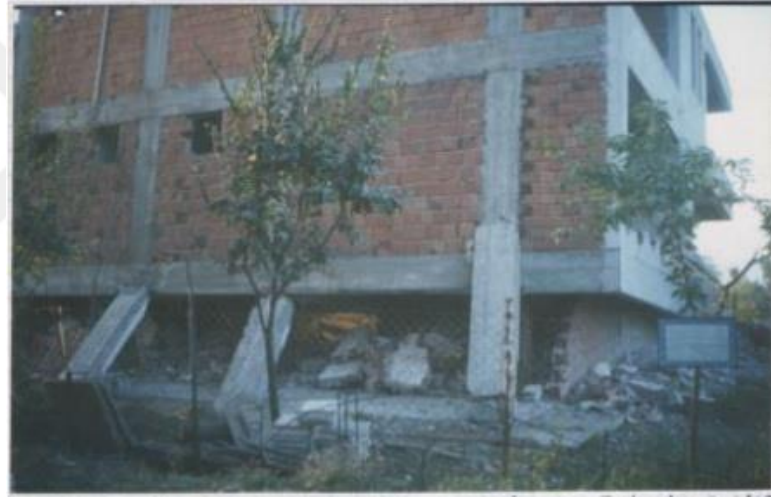
Şekil 1.7. Kocaeli depremi sırasında gerçekleşen yumuşak kat ve zayıf kat hasarı [3]
