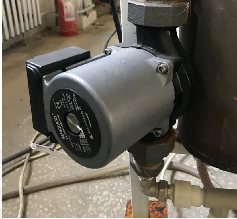
Şekil 3.3. Sistemde kullanılan sirkülasyon pompası
