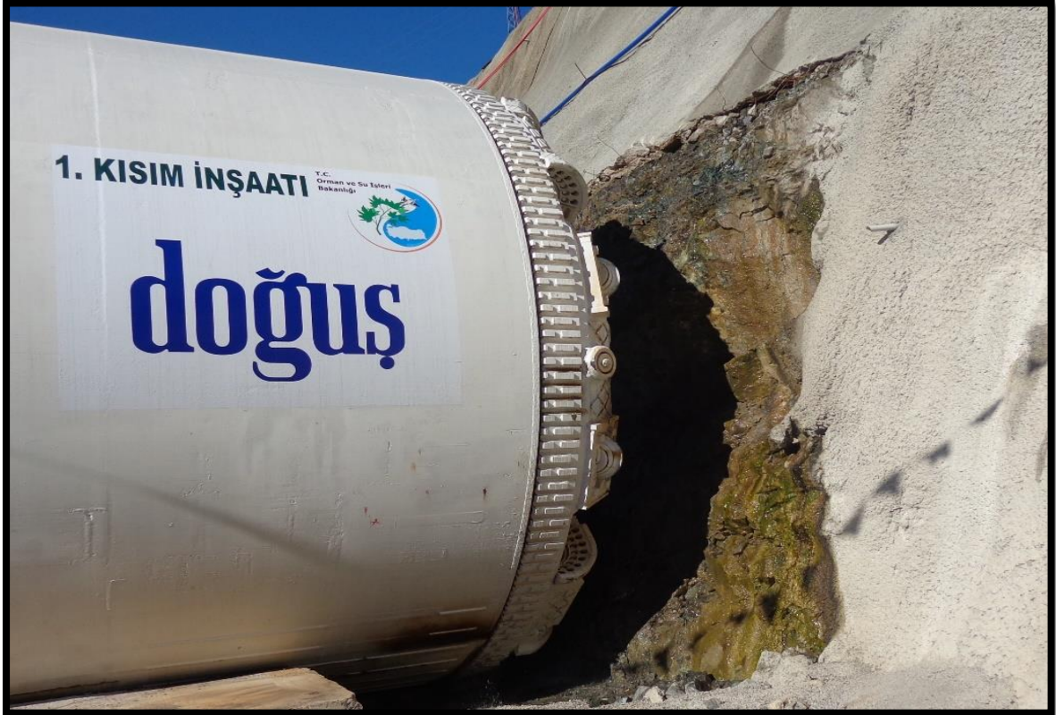
Şekil 5.13. EPB/TBM'in yakından görünümü
