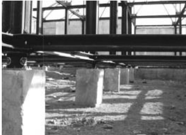
Şekil 4. 20: Hamamdaki sismik izolatör sistemi.
