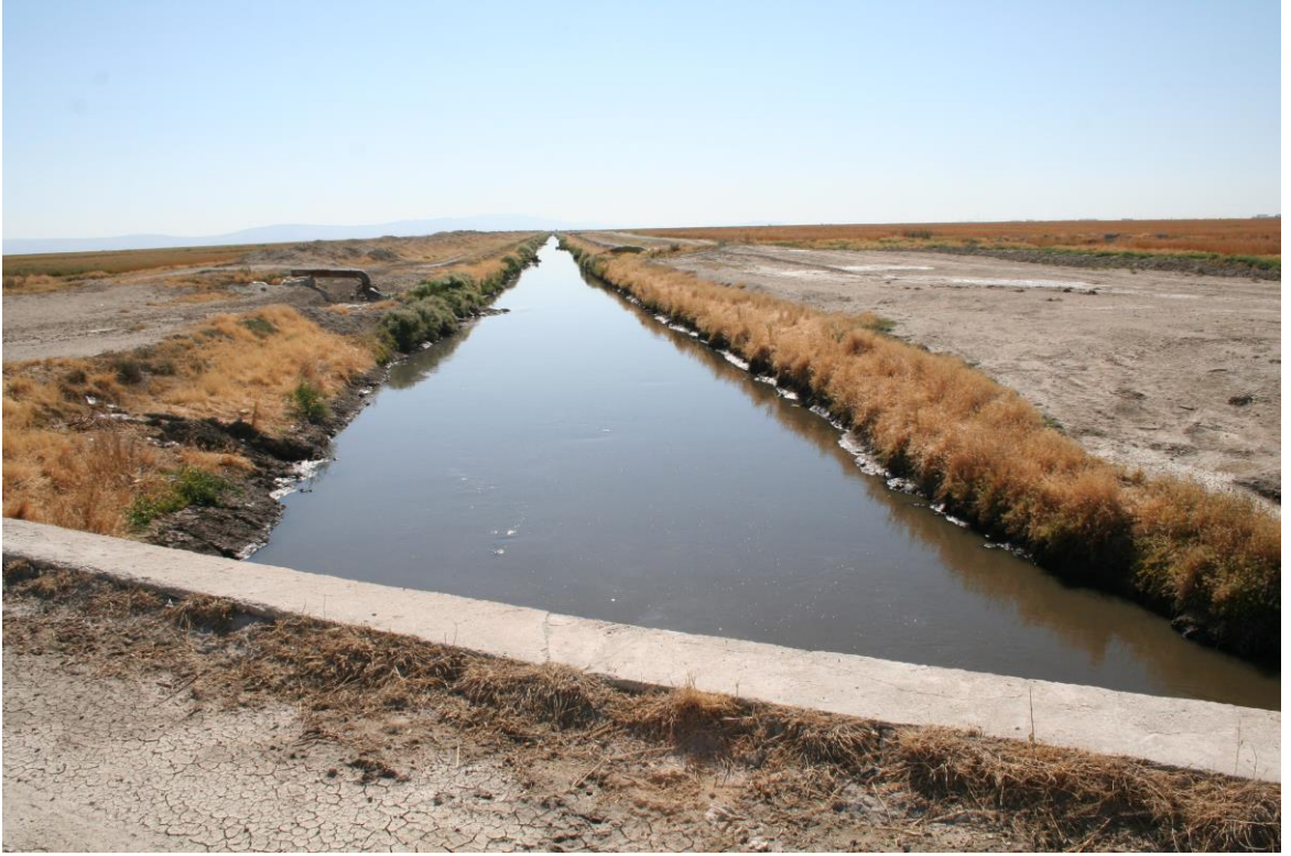
Şekil 3.15. Apa Tahliye Kanalı - Pompa No:1 girişi
