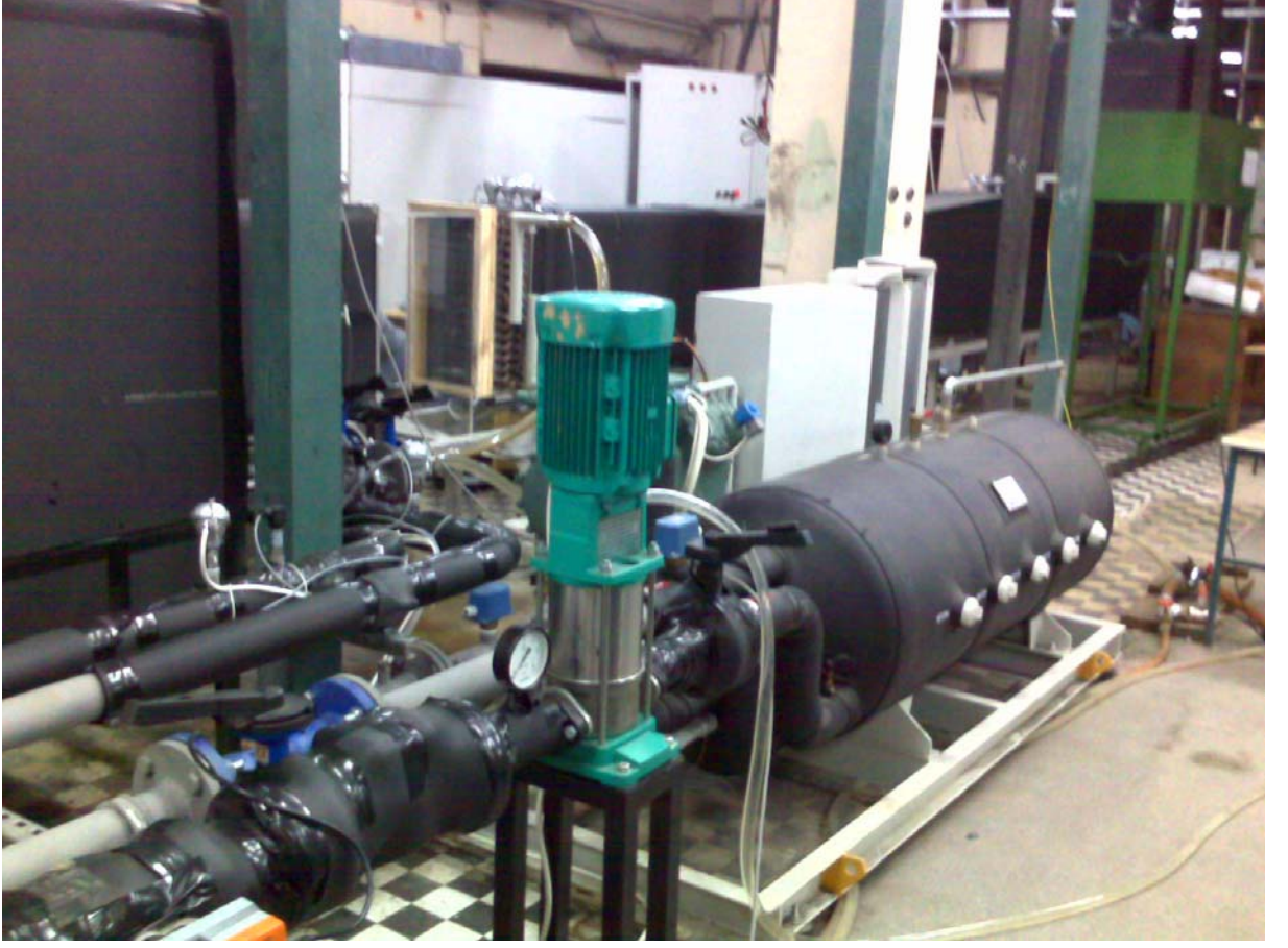
Şekil 3.7 Su soğutucu grubun fotoğrafı
