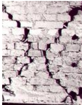
Şekil 2. 14 Depremden dolayı oluşan çatlak
