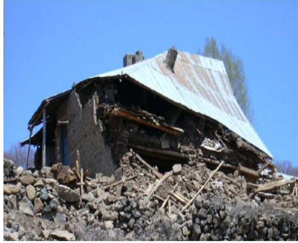
Şekil 2. 22 Yeteri kadar bileşeni olmayan yığma yapıda meydana gelen hasar.(YDGA-2005)
