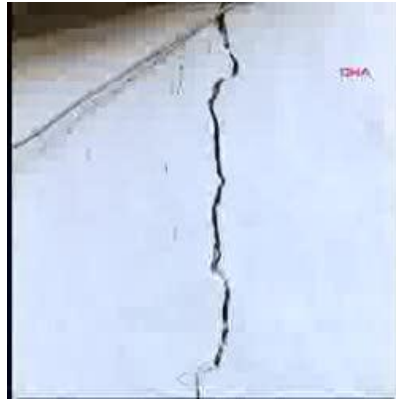
Şekil 2. 13 Statik ve zati yüklerden dolayı oluşan çatlak
