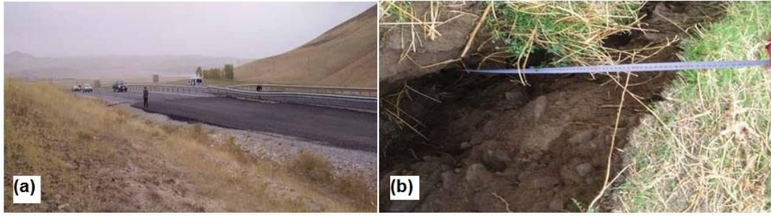
Şekil 1.21 : (a) Van-Erciş yolu üzerinde Gedikbulak Köyü yakında karayolu hasarı ve onarımı. (b) Van-Erciş Karayolu şev kayması çatlakları.
