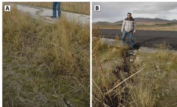
Şekil 1.17 : Yollarda meydana gelen ikincil deformasyonlar. (a) Van-Topaktaş yolu üzeri, hapishane yanı, (b) Van-Erciş yolu TOKİ konutları yanı.
