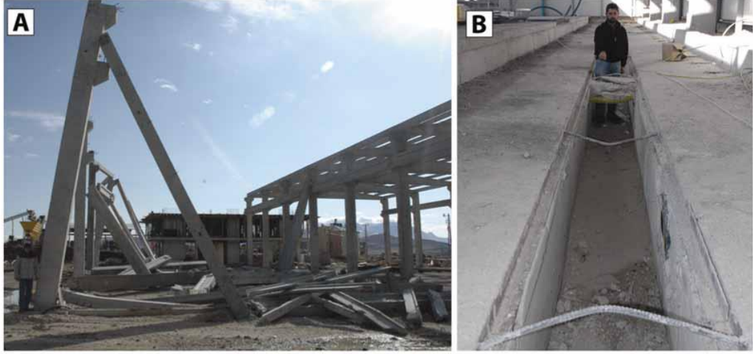
Şekil 1.18 : (a) K-G sıkışmayı gösteren güneye yıkılmış kolonlar, (b) Organize sanayi bölgesinde demir çubuklarda gözlenen K-G yönlü sıkışma yapıları.
