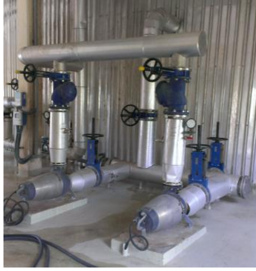
Şekil 4.4 Tokat AAT Resirkülasyon pompası
