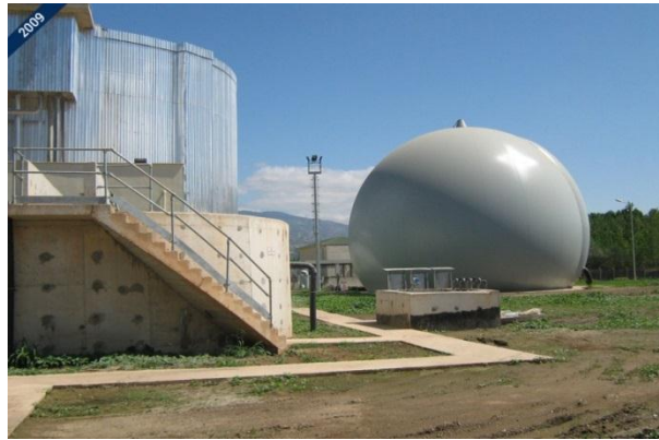
Şekil 2.1 Tokat AAT'ne ait çamur homojenizasyon tankı ve biyogaz depolama tankından bir görünüş
