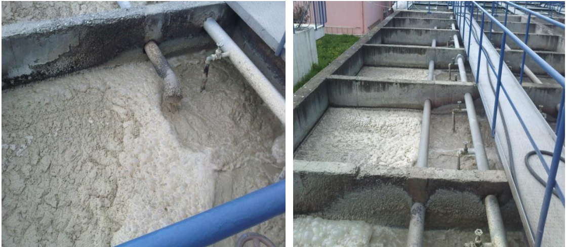
Şekil 4.12 Tokat AAT havalandırma ve çöktürme havuzları
