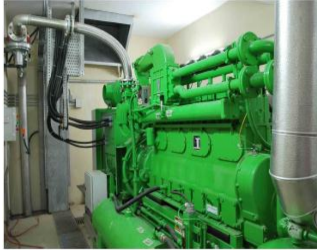
Şekil 4.9 Tokat AAT kojenerasyon ünitesi
