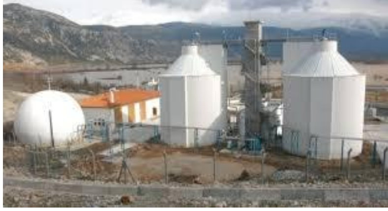
Şekil 2.3 Muğla AAT kojenerasyon santralinden bir görünüş
