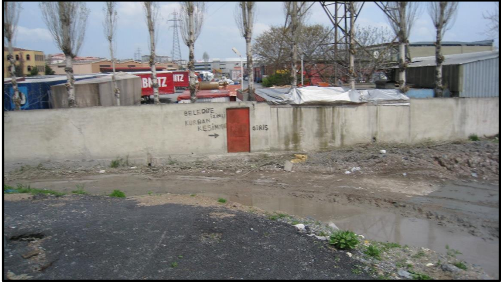
Şekil 5.5: İkitelli Tır Garajı duvarlarının dere akışını yanlış yönlendirmesi.
