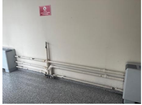
Resim 5. 17. Koridorlarda bulunan sıhhi tesisat
