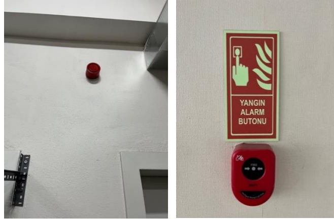
Resim 5. 19. Yangın algılama ve alarm sistemleri
