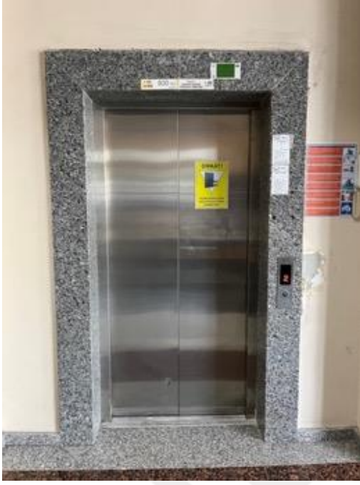
Resim 5. 26. Katlarda bulunan asansör
