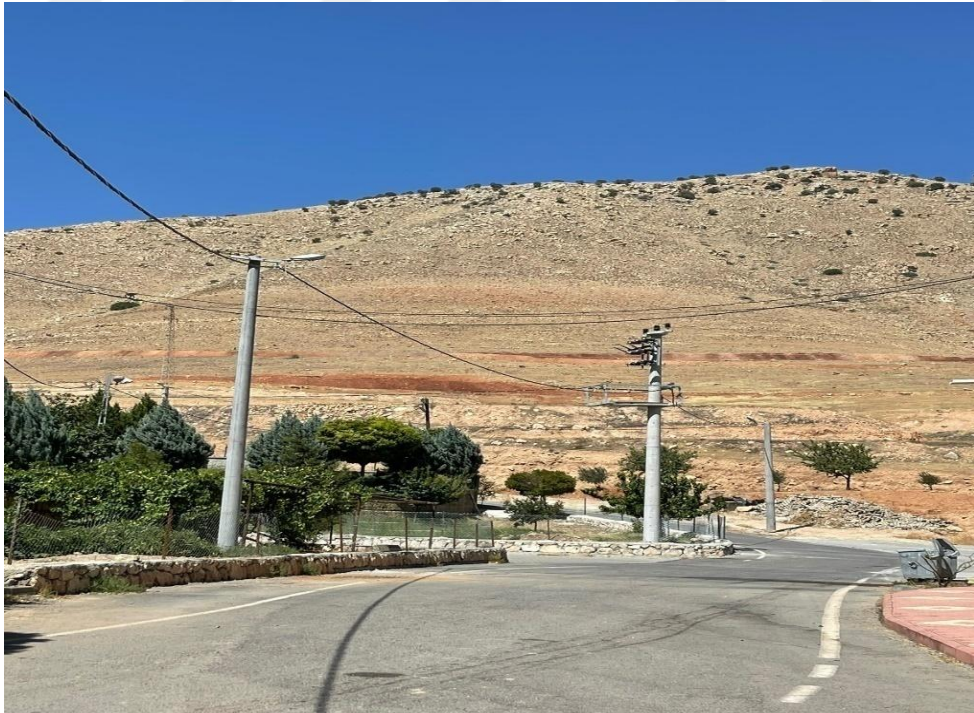
Şekil 3.6. Havai Alçak Gerilim Hattı
