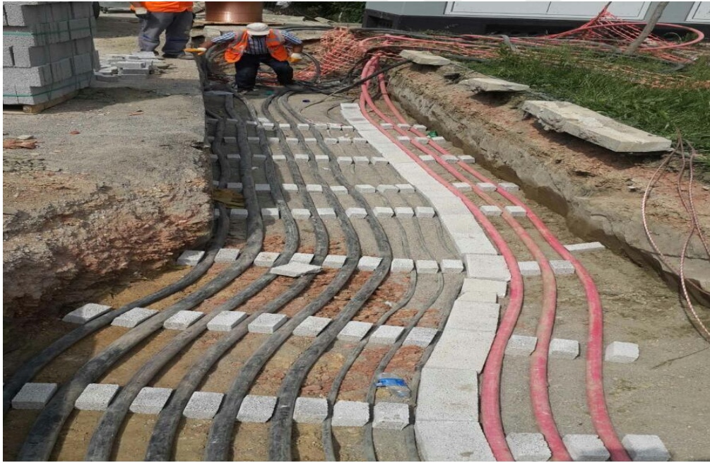
Şekil 3.7. Yeraltı Hatları orta gerilim ve alçak gerilim (Müşterek) Hatlar
