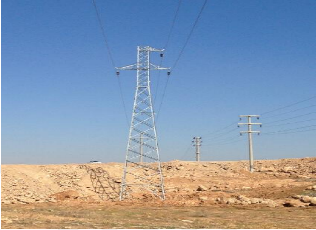
Şekil 3.5. Havai Orta Gerilim Hattı
