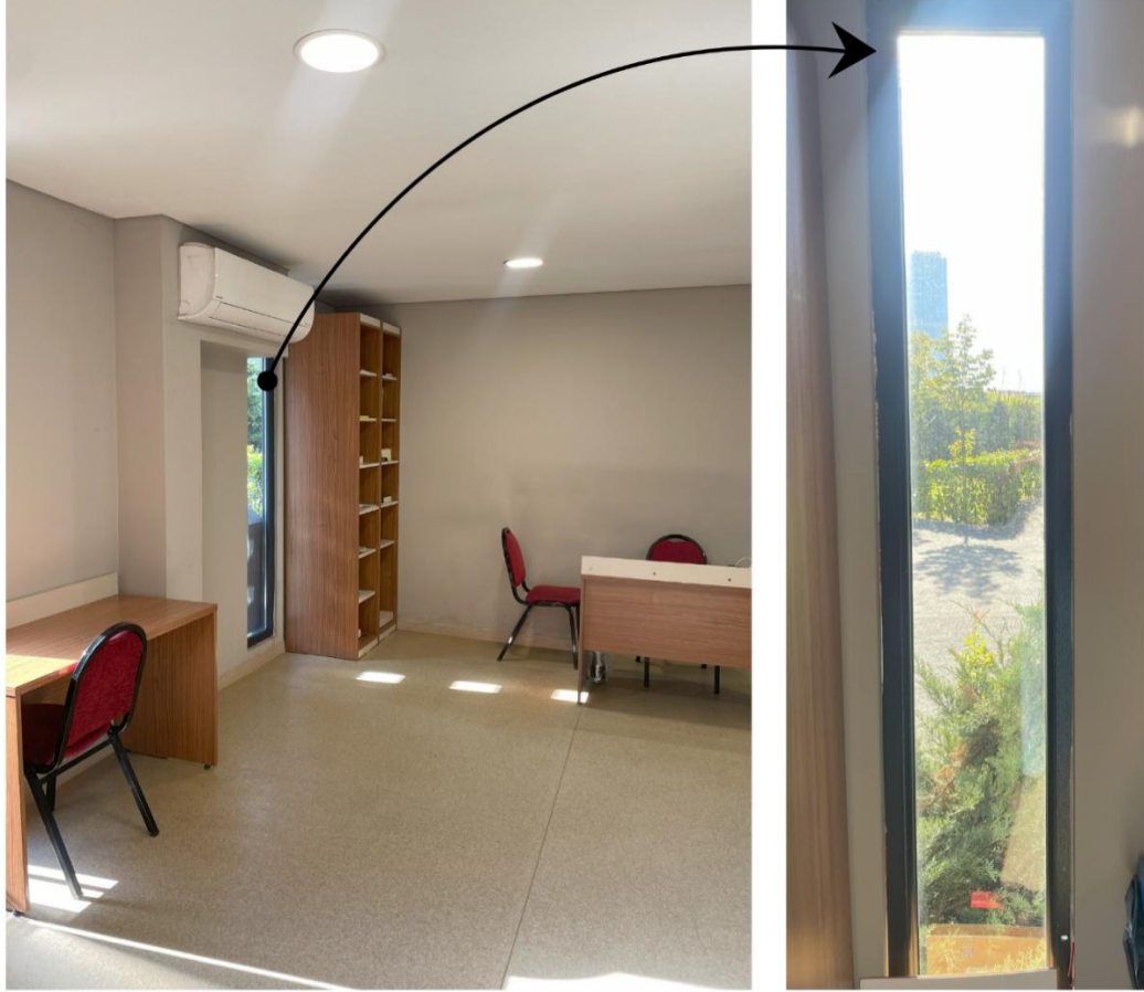
Şekil 63. Sabit cam kullanımı nedeniyle sınırlı doğal havalandırmaya sahip iç mekân örneği (Paria Tanha, 2025).
