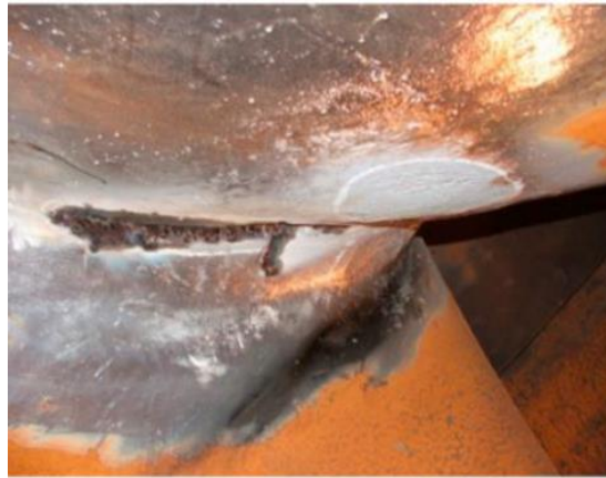
Şekil 4.2. Kılavuz kanadına ait bir eroziyon aşınma örneği [58].
