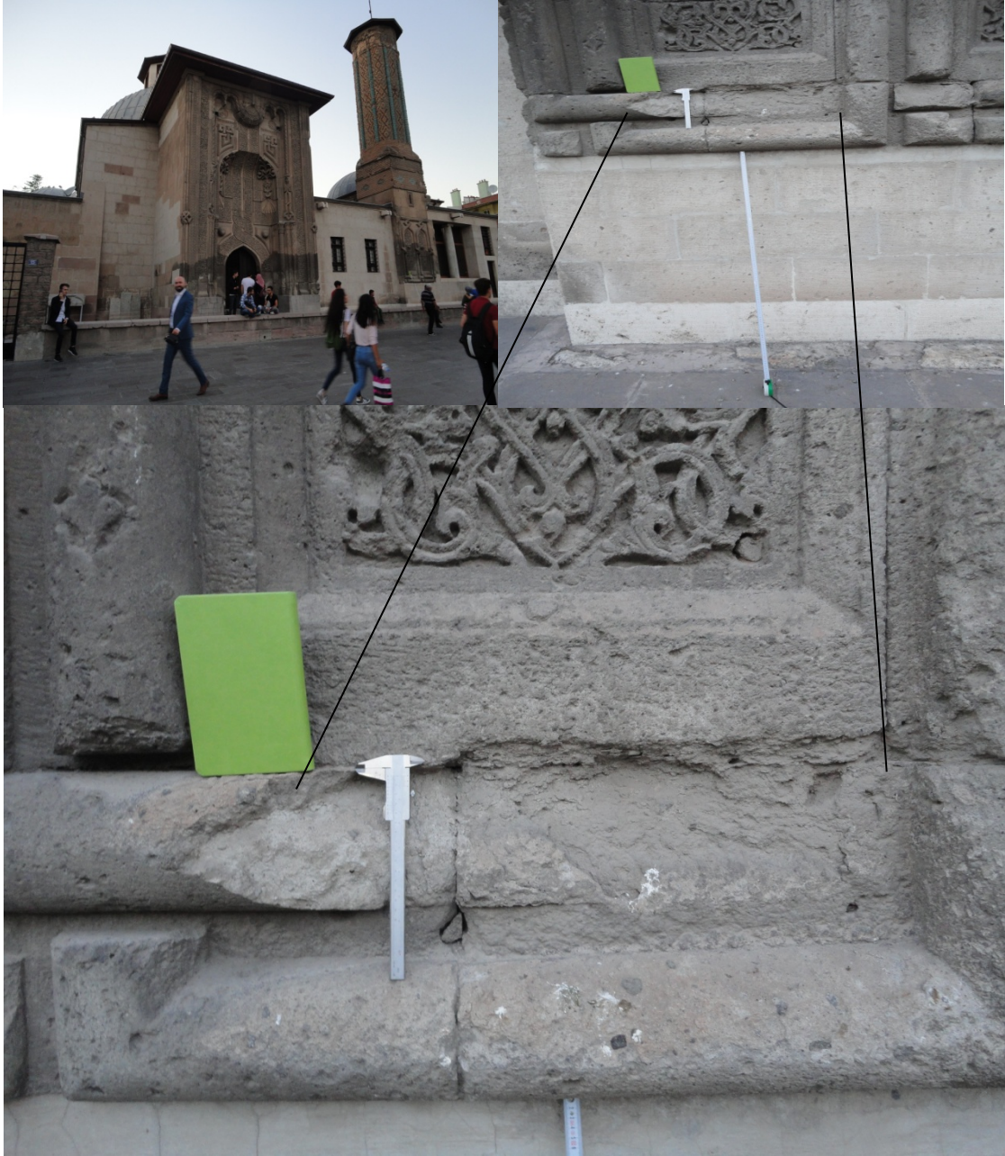
Şekil 5.9. Selçuklu ilçesine bağlı İnce Minareli Medresenin kaplamasında kullanılan trakitte kopma sonucu meydana gelen bozunma örneği.
