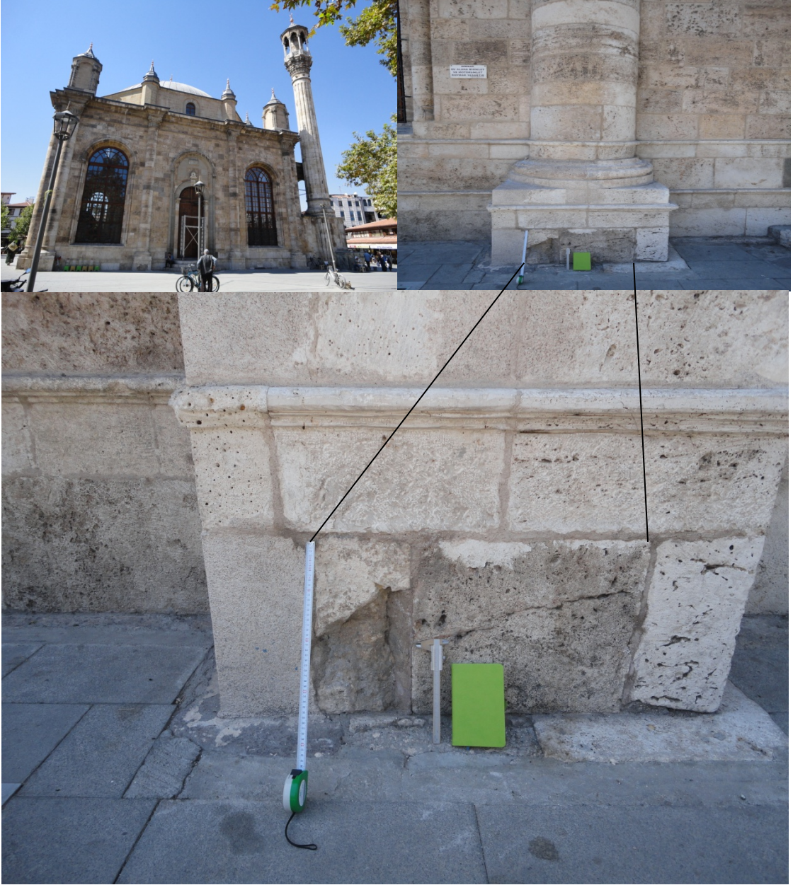
Şekil 5.7. Karatay ilçesine bağlı Aziziye Camii'nin kaplamasında kullanılan travertende kopma sonucu meydana gelen bozunma örneği.
