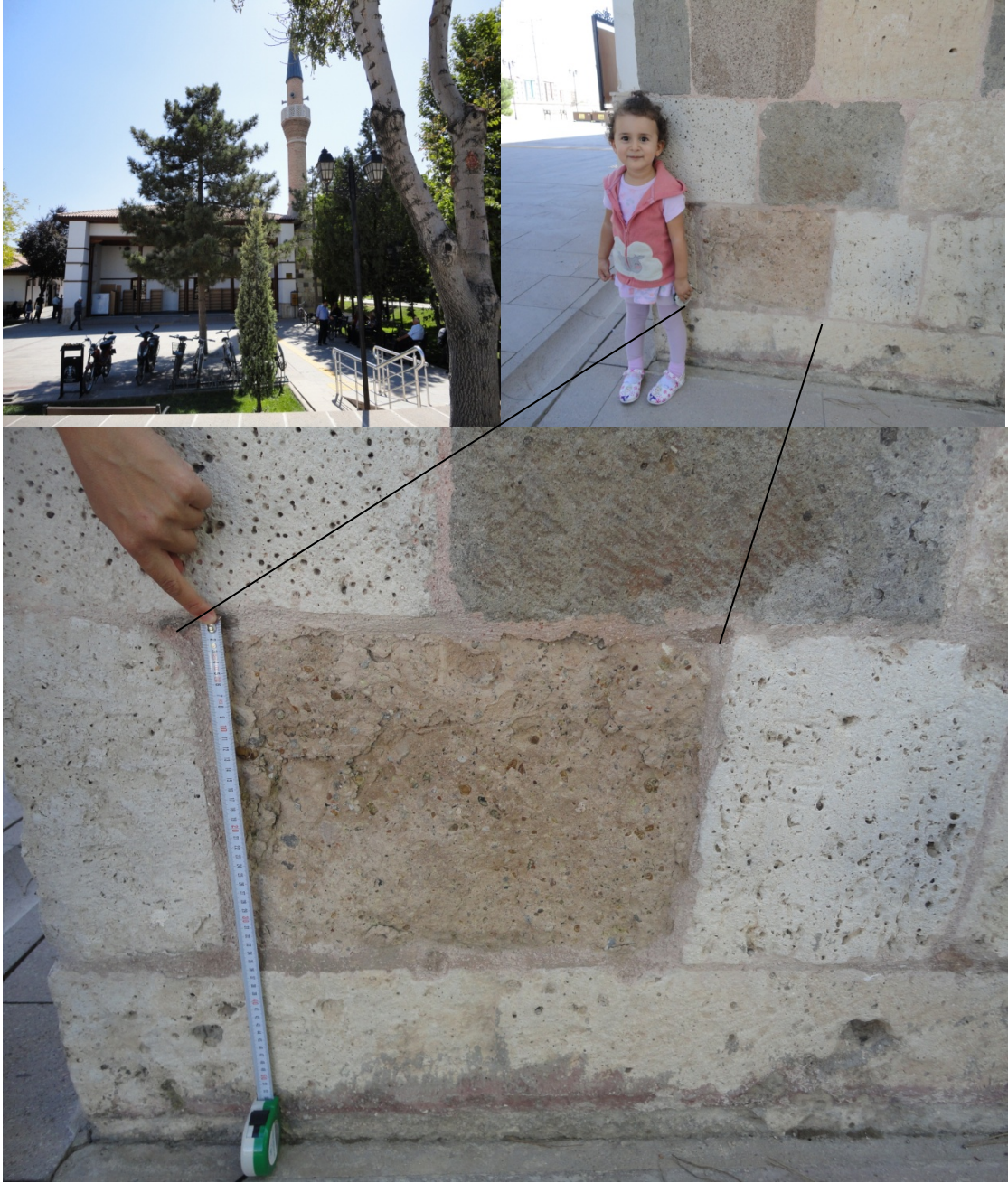
Şekil 5.6. Karatay ilçesine bağlı Hacı Veyis Camii'nin minaresinde kullanılan tüfte aşınma sonucu meydana gelen bozunma örneği.
