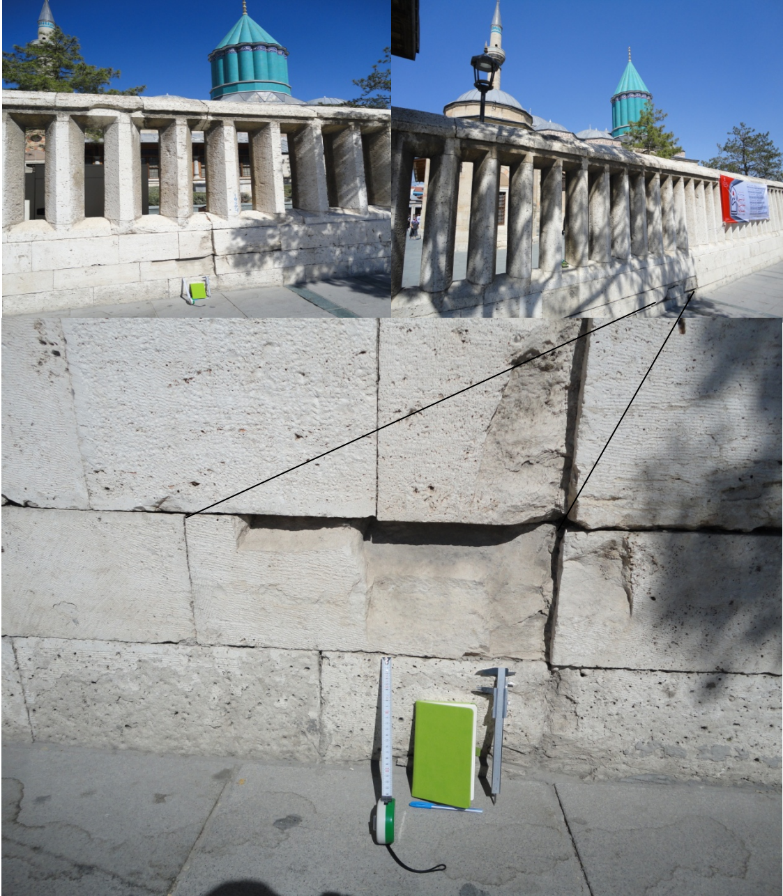
Şekil 5.8. Karatay ilçesine bağlı Mevlâna Türbesi ve Dergâhı'nın bahçe duvarlarında kullanılan travertende meydana gelen kopma örneği.
