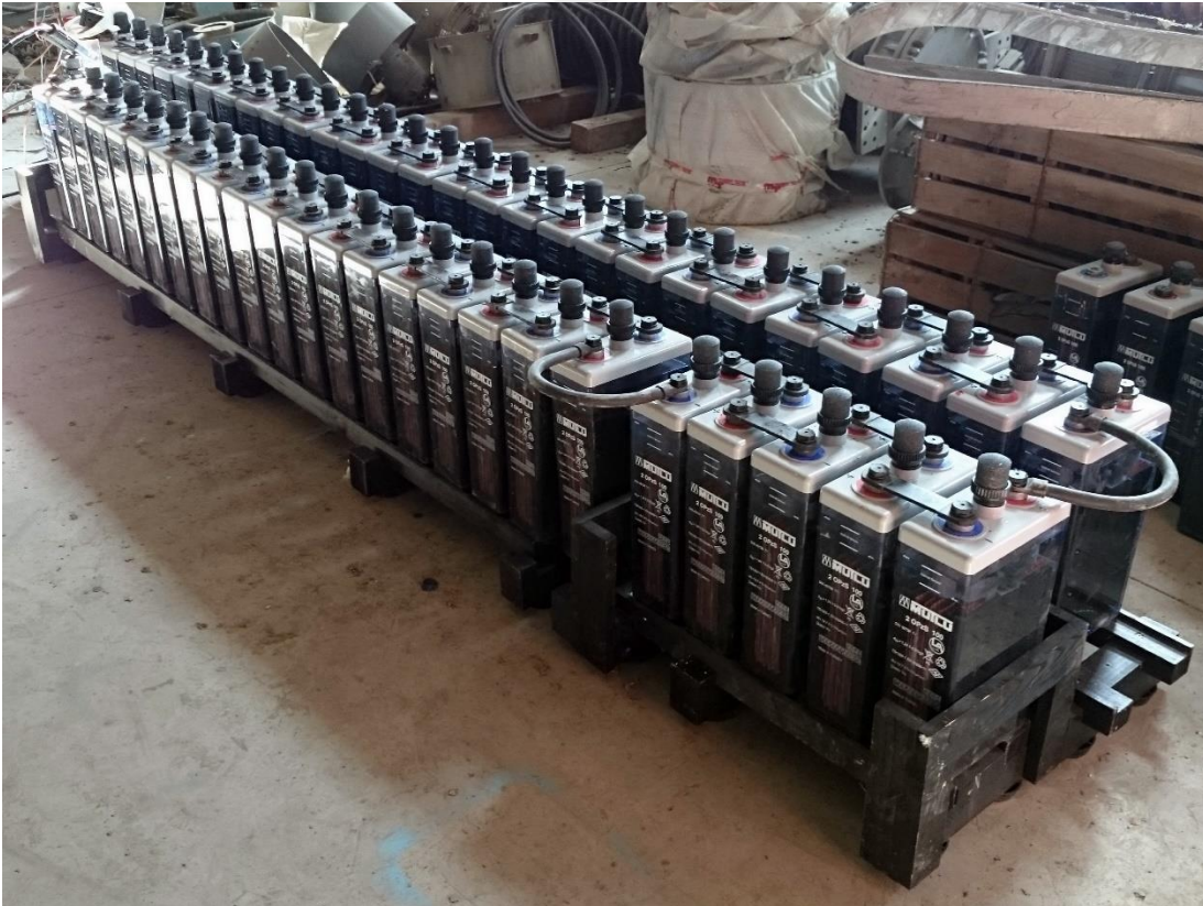
Şekil 4.33 : Test ve ölçümü yapılan akü bankası.
