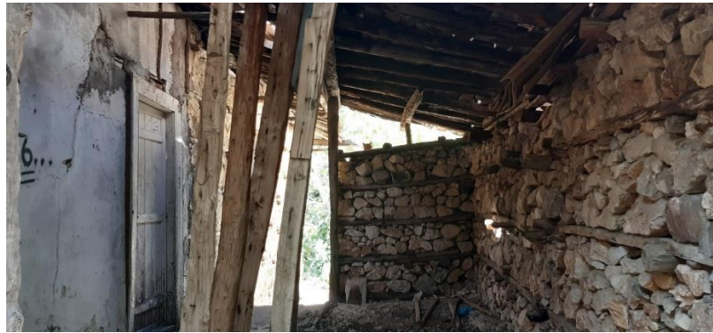
Şekil 3.25 Müdahale edilmemiş ve terkedilmiş yapının iç bölümü (2019)
