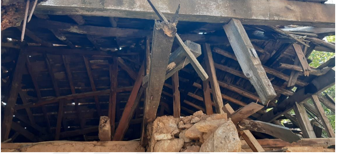
Şekil 3.18 Harap haldeki yapıda görülen çatı detayı (2019)
