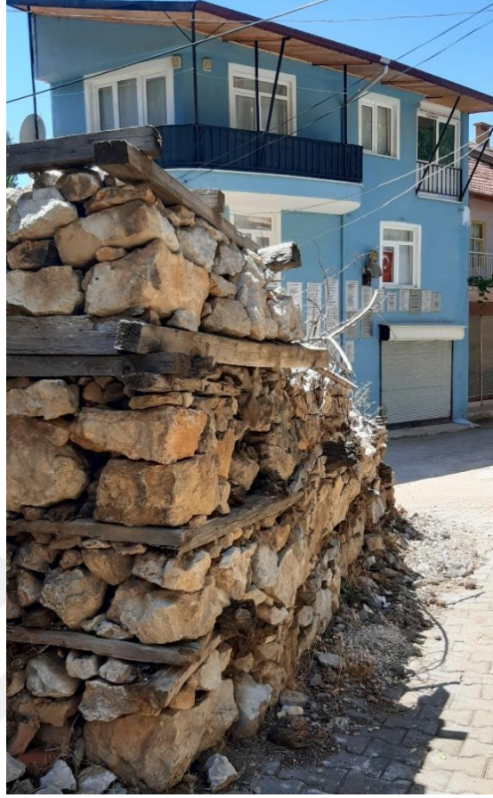
Şekil 3.72 Yıkılmış durumdaki Düğmeli Ev örneği (2020)
