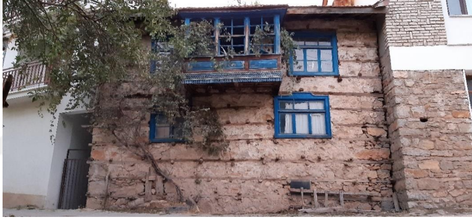
Şekil 3.82 Kullanılmayan kötü durumdaki Düğmeli Ev örneği (2019)
