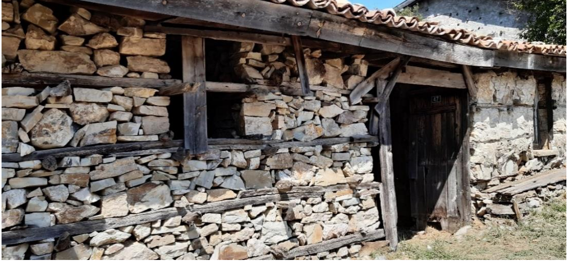
Şekil 3.42 Belenalan Mahallesi kötü durumda Düğmeli Ev örneği. (2019)
