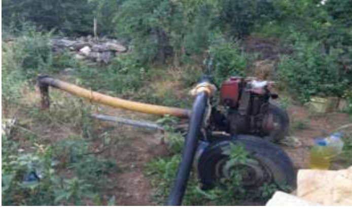
Şekil 3. 5. Denemede kullanılan kuyu ve pompaj sistemi
