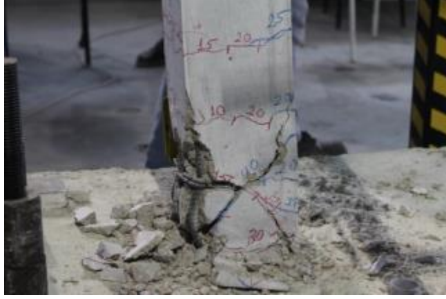
Şekil 5.3. Kolon alt ucu hasarı (Numune 1)
