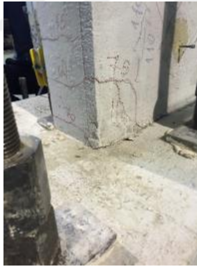
Şekil 5.49. Güçlendirme sıvasının köşe hasarı (BÇN-10)
