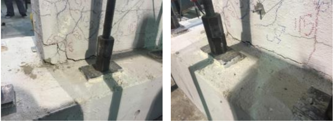
Şekil 5.61. Güçlendirme sıvası ile temel ayrılma çatlağı (BÇN-11)
