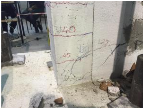
Şekil 5.35. Dolgu duvar ve kolon hasarı (BÇN-7)
