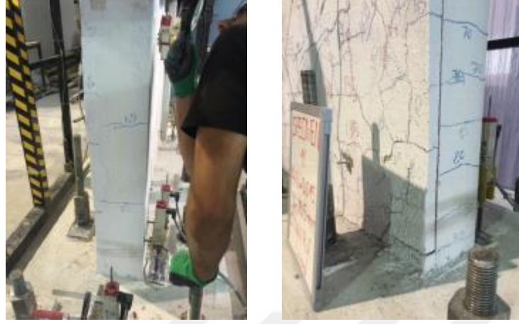
Şekil 5.58. Güçlendirme sıvası ile kolon ayrışma çatlağı (BÇN-11)
