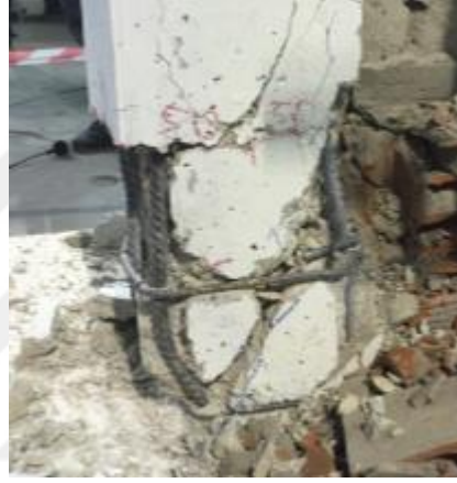
Şekil 5.24. Kolon alt ucunda etriye açılması (BÇN-5)
