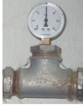
Resim 2.13. Boru başına yerleştirilen manometre
