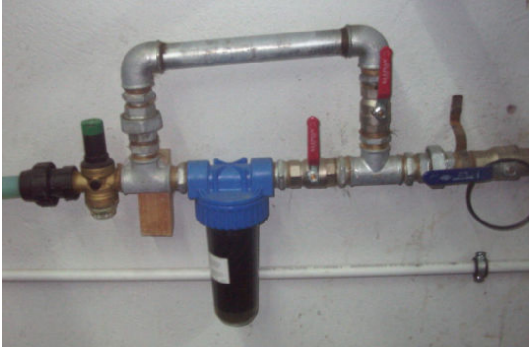
Resim 2.14. Boru düzeneği başındaki bypass sistemi ve aktif karbon filtre
