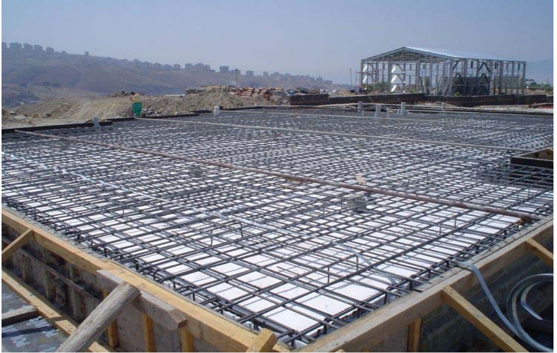
Şekil 5.5 Yalıtım sonrası kalıp kurulması, temel donatısının bağlanması, topraklama şeridinin geçirilmesi, zemin kat atık su tesisatlarının döşenmesi ve betona hazırlık
