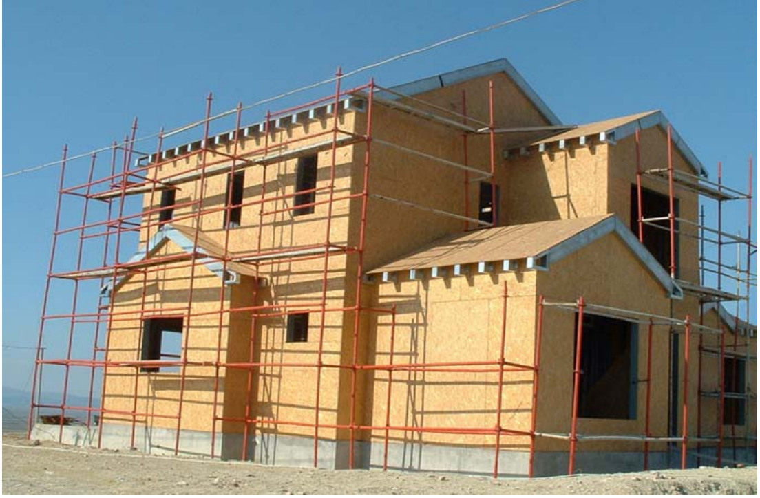
Şekil 5.18 Cephe iskelesi kurulduktan sonra OSB cephe kaplamalarının tamamlanması ve saçak profillerinin montajı
