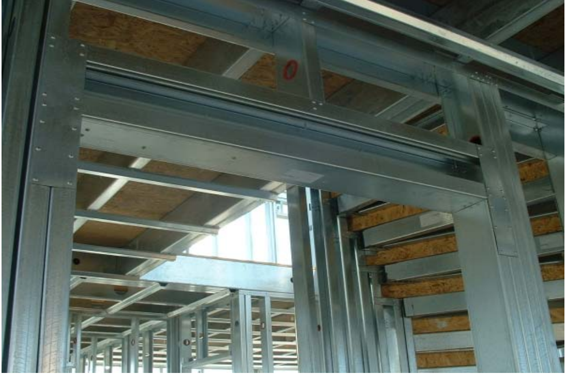
Şekil 5.10 Taşıyıcı lento detayı (üzerine çift taraftan döşeme kirişinin bastığı panelin kapı üstü lentosu taşıyıcı olarak tasarlanmıştır)
