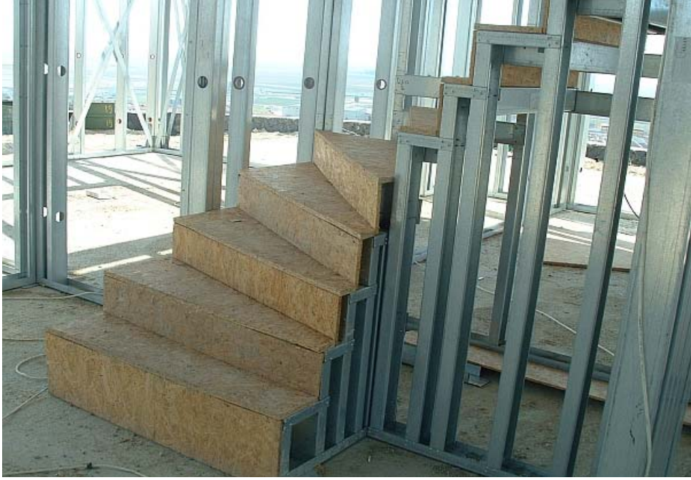
Şekil 5.16 Binanın merdiveni (merdiven duvarları dikildikten sonra, C profillerle atölyede oluşturulmuş olan merdiven basamaklarının monte edilmesi ve basamakların üzerine 18 mm kalınlığında OSB plaka kaplanması)
