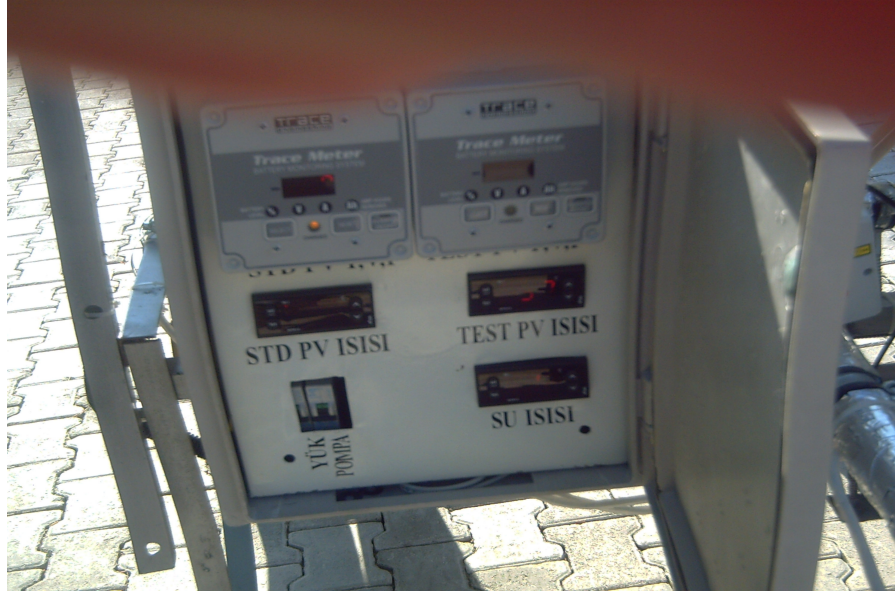
Şekil 3.8. Test sisteminde ölçüm değerlerinin alındığı kontrol paneli
