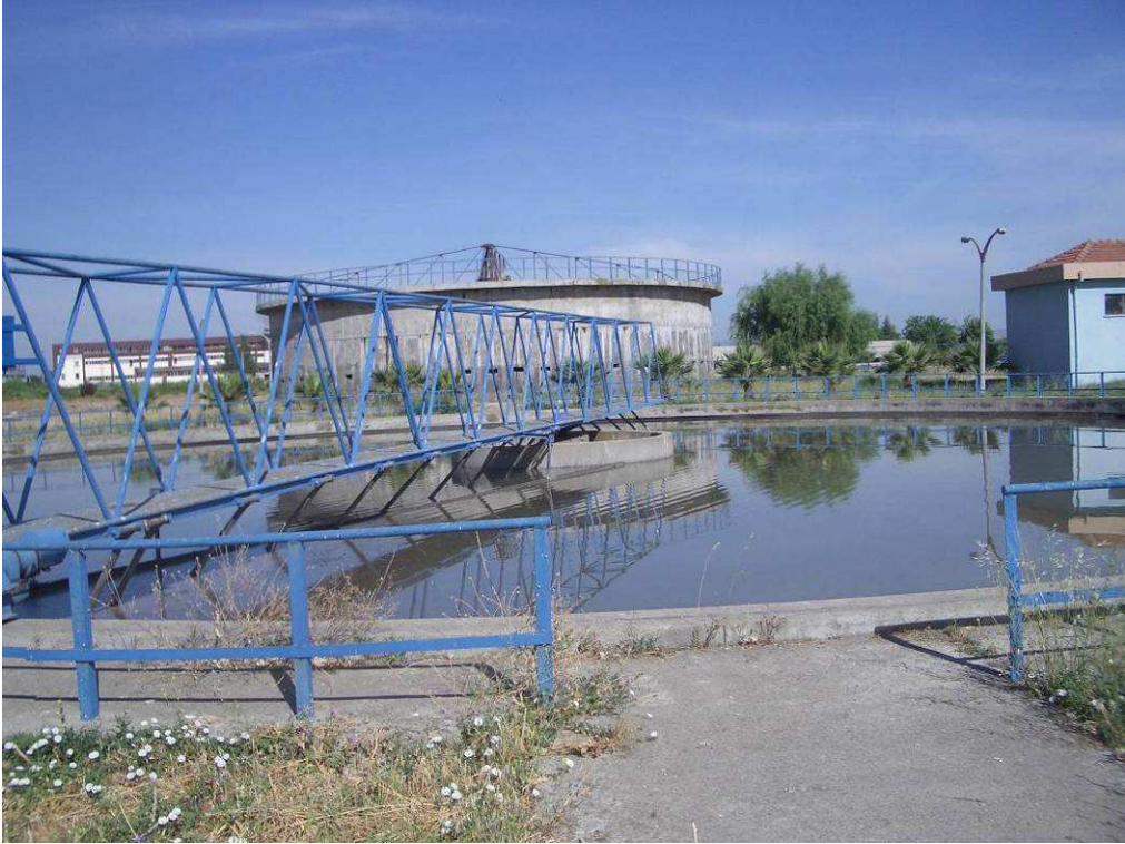
Şekil 4.1.1.3.1: Manisa Belediyesi Evsel Atık Su Arıtım Tesislerine ait genel görünüş.
