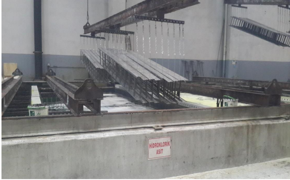
Şekil 4.16: Sıcak daldırma galvaniz HCL asit prosesi
