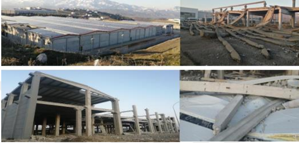
Şekil 11. Kahramanmaraş’ta Prefabrik Sanayi Binası Bağlantı Hasarlarına Genel Bakış
