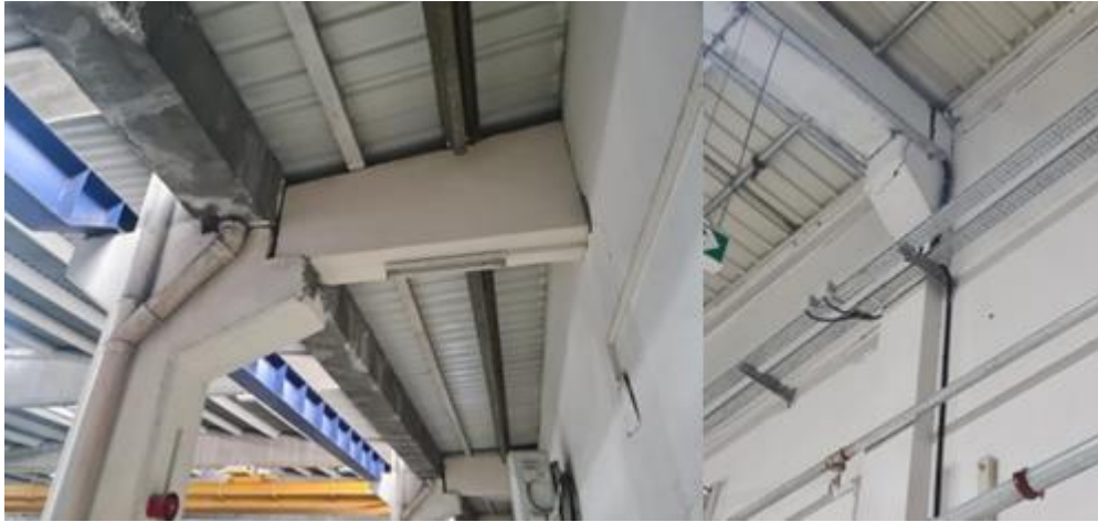
Şekil 12. Gaziantep’teki Sanayi Yapıları Hasarları
