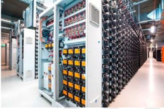
Şekil 29: Enerji Depolama Sisteminin İç Yapısı
