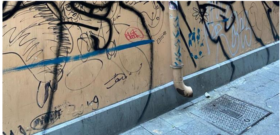
Şekil 2. 64 Narmanlı Han Restorasyon Sonrası Yağmur İnişi
