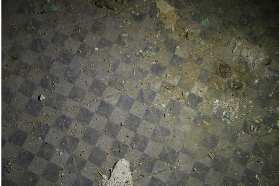
Şekil 2. 54 Restorasyon Öncesi Zemin Orijinal Döşemesi
