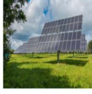
Güneş enerjili elektrik paneli
