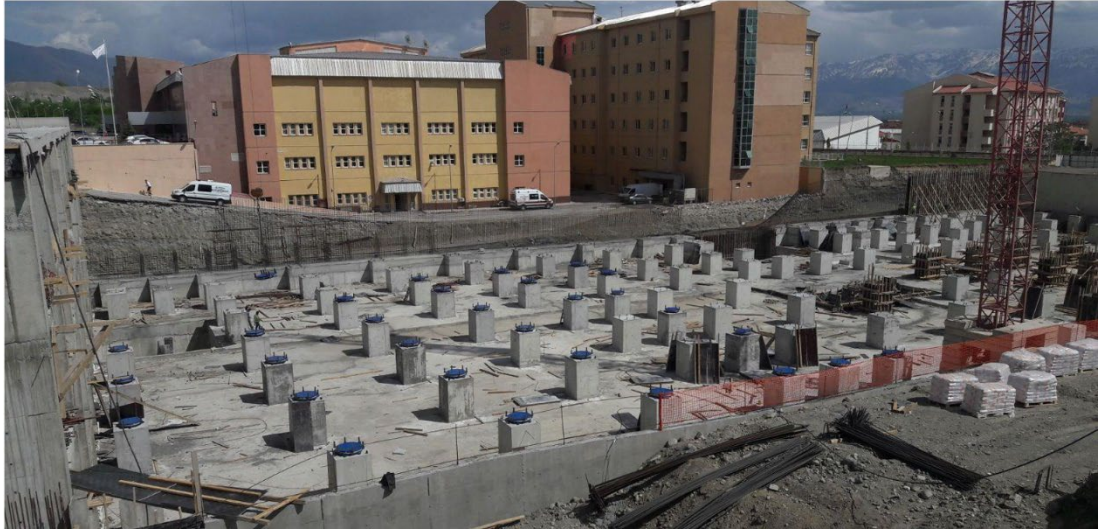
Şekil 1.16. İzolatörlerin Sahadan Genel Görünüşü
