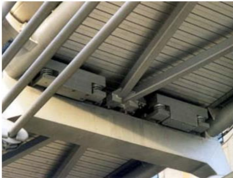
Şekil 2.23: Londra'daki Millenium Yayı Köprüsü'nün güvertesinin altına yerleştirilen dikey TMD'ler. [22].
