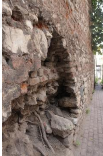
Şekil 3.24. Yığma duvarın şişmesi ve duvarda oluşan yığma taşıyıcı eleman deformasyonu [14]
