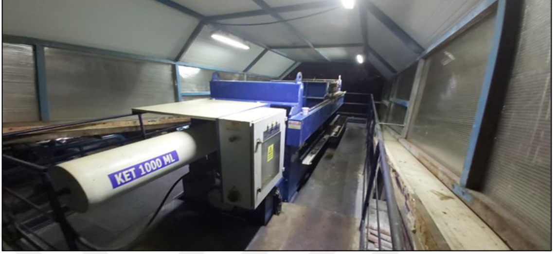
Şekil 4.3. Tesis filtre pres ünitesi
