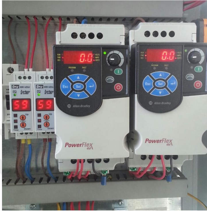
Şekil 3.20 : Mekanik titreşim sisteminin elektrik panosu.
