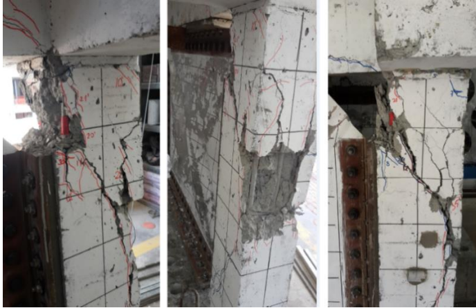
Şekil 6.15: Kolonlarda meydana gelen çatlak ve kopmalar.
