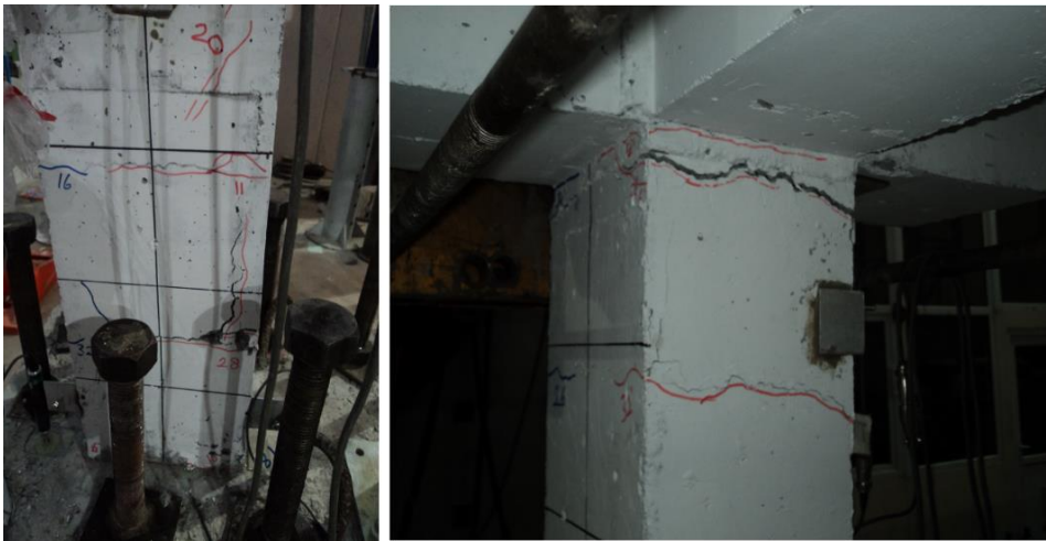
Şekil 6.6: Numunede gözlemlenen dökülmeler ve derin çatlaklar.
