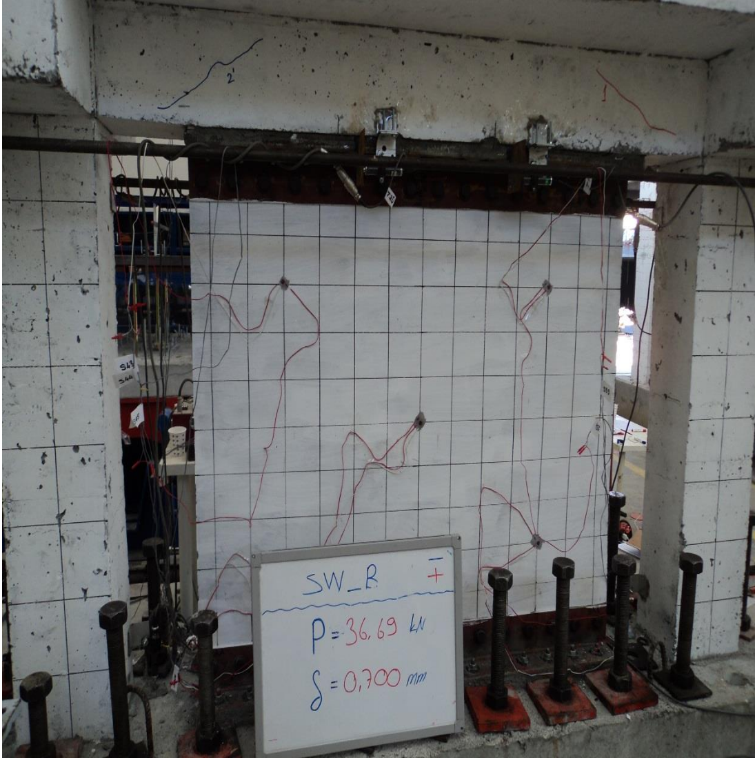
Şekil 6.18: 7. adımda kirişte meydana gelen çatlaklar.
