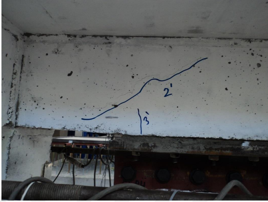
Şekil 6.19: Betonarme kirişlerde oluşmaya başlayan çatlaklar.
