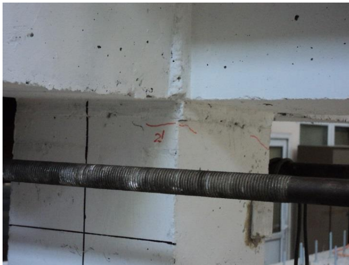
Şekil 6.3: Yalın çerçeve kolon – kiriş birleşim bölgesinde gözlemlenen ilk çatlaklar.
