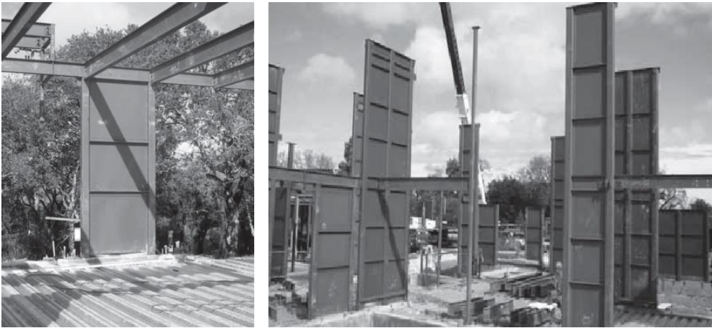
Şeki 1.2 : İnce çelik levhalar ile teşkil edilmiş perde sistemler (Sabelli, R. ve Bruneau, M., A.I.S.C. Steel Design Guide 20 : Steel Plate Shear Walls , 2006).
