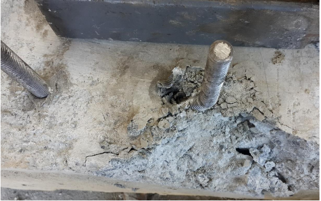
Şekil 5.16: Ankraj bulonu kayma testi sonucu meydana gelen deformasyonlar.
