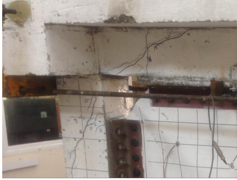
Şekil 6.12: 13. adım sonunda kolon-kiriş birleşim bölgesi çatlakları.
