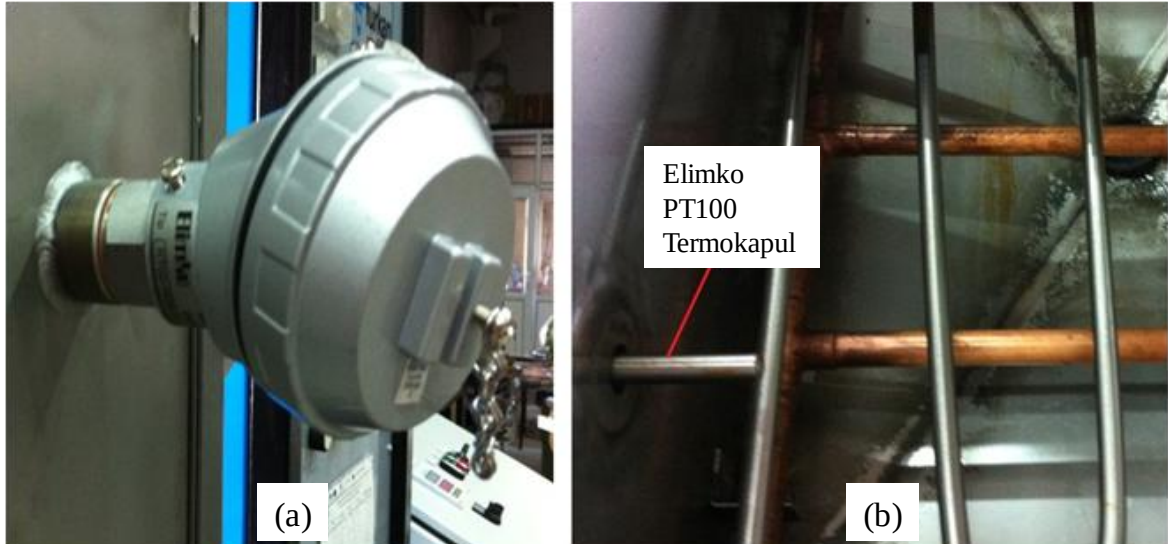
Şekil 4.8. Elimko PT100 termokapılın: a) tank dışı görünüşü, b) tank içi görünüşü
