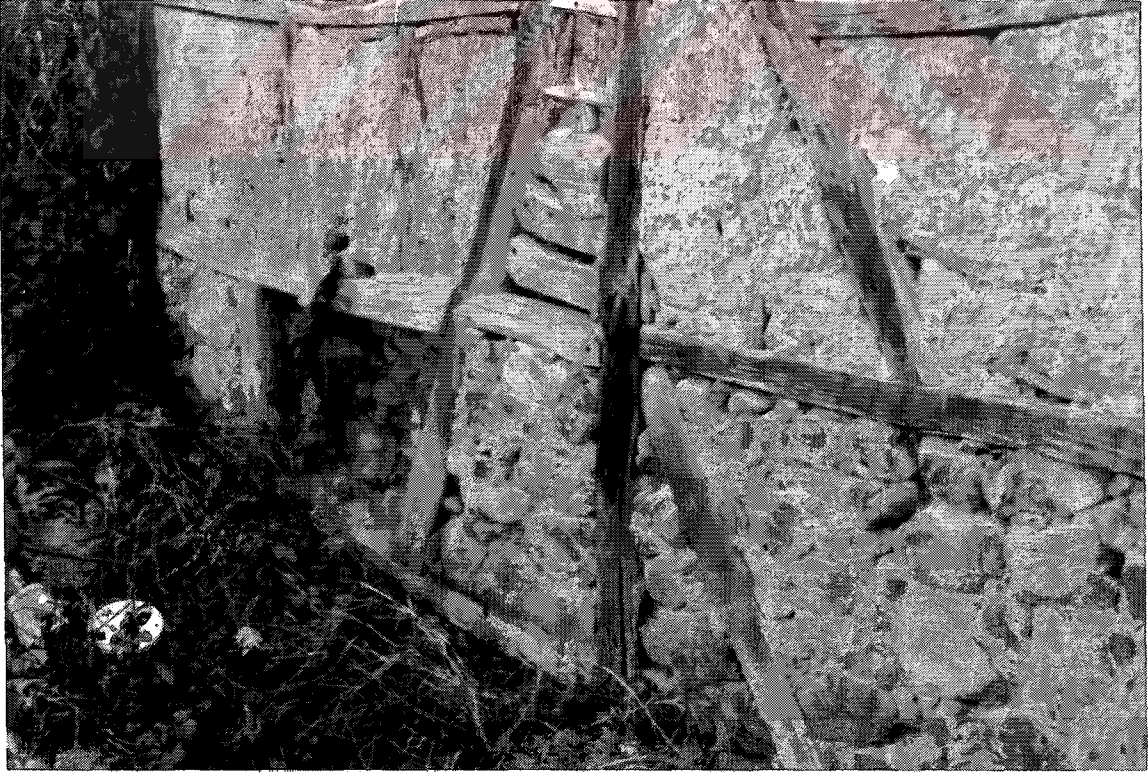
Şekil E.118 Değirmendere, zemin katın bir bölümünde ahşap iskelet arası taş dolgu
