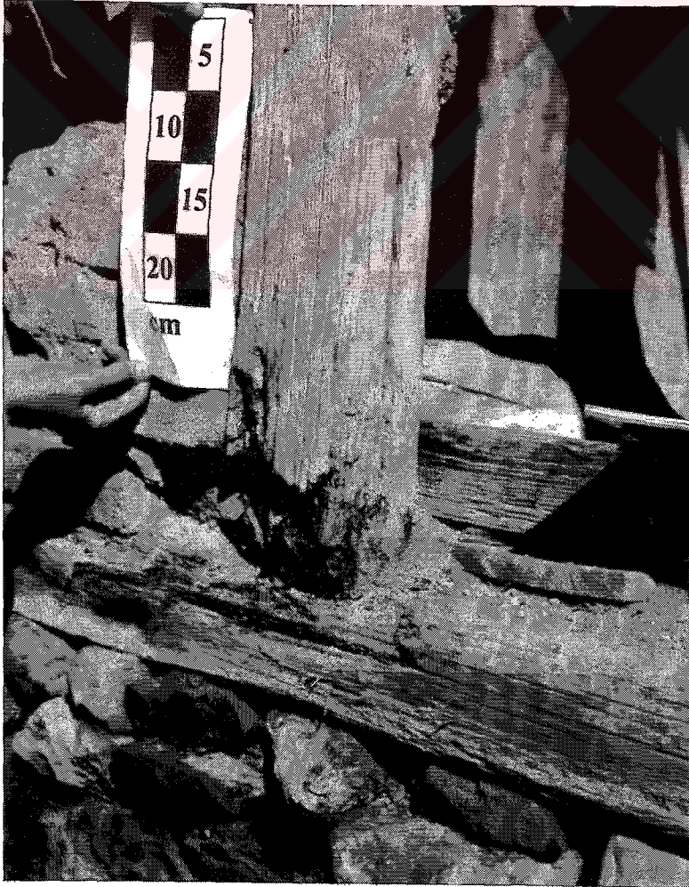
Şekil D.61 Düzce Konuralp, Çarşıci Caddesi No. 2, ahşap elemanların niteliklerini kaybetmesi nedeniyle çivilerin işlevini yitirmesi
