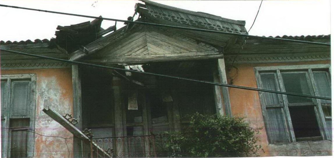
Şekil D.76 Gebze Tavşancıl, balkon saçaklarında hasar
