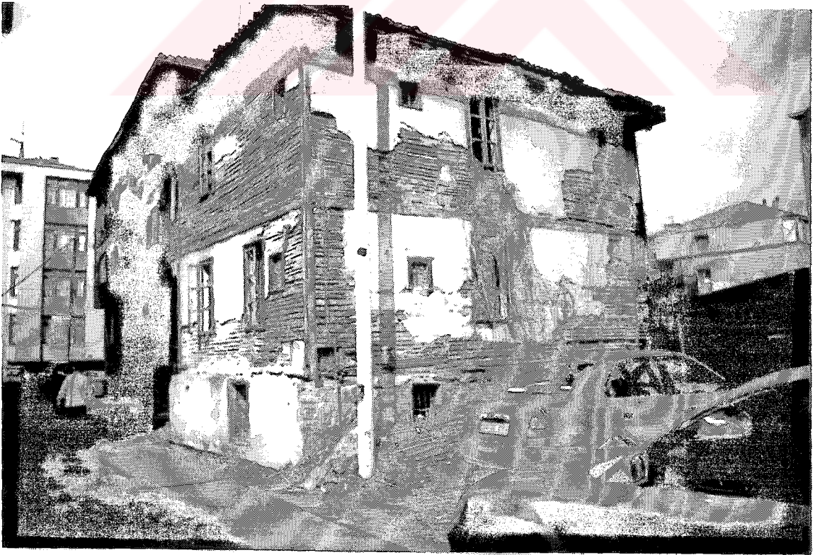
Şekil D.71 Adapazarı, 17 Ağustos 1999 Kocaeli depreminde sıvası dökülen yapı örnekleri
