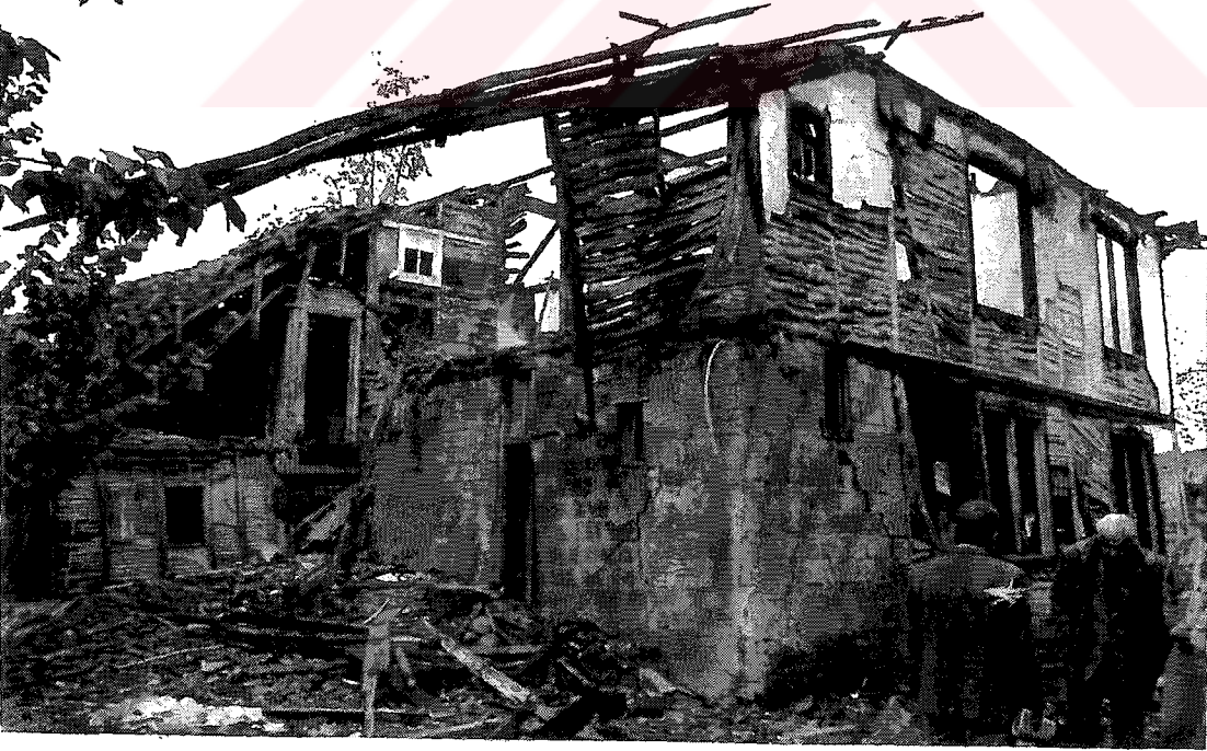
Şekil D.79 Sapanca, kısmen yıkılmış ahşap iskeletli yapı ( KTBKTVK Bursa Bölge Kurulu arşivi )
