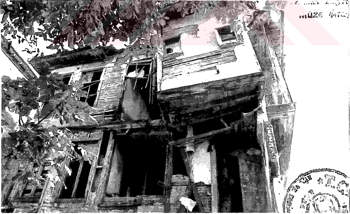
Şekil D.41 Adapazarı, yapının arka cephesindeki çıkmada oynama
