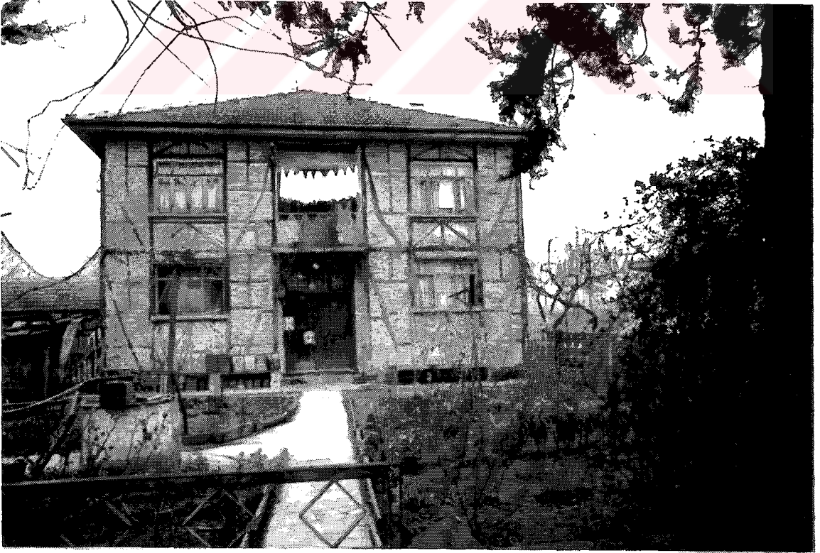
Şekil D.54 17 Ağustos 1999 Kocaeli depremi, Adapazarı, Büyükesence Köyü ahşap karkas yapıda yanal ötelenme ve hasarsız ahşap iskeletli yapı
