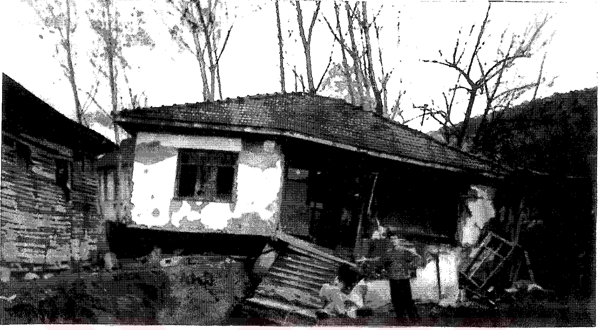
Şekil D.5 Düzce, Çakırbrahim Köyü, faylanmadan dolayı yan yatmış ve burulmaya maruz kalmış tek katlı hımış ev ( Değirmendere Belediyesi arşivi )
