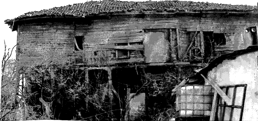
Şekil D.19 Yalova Denizcali Köyü 1999, zemin katı hasarlı yapı ( muhtarın evi )
