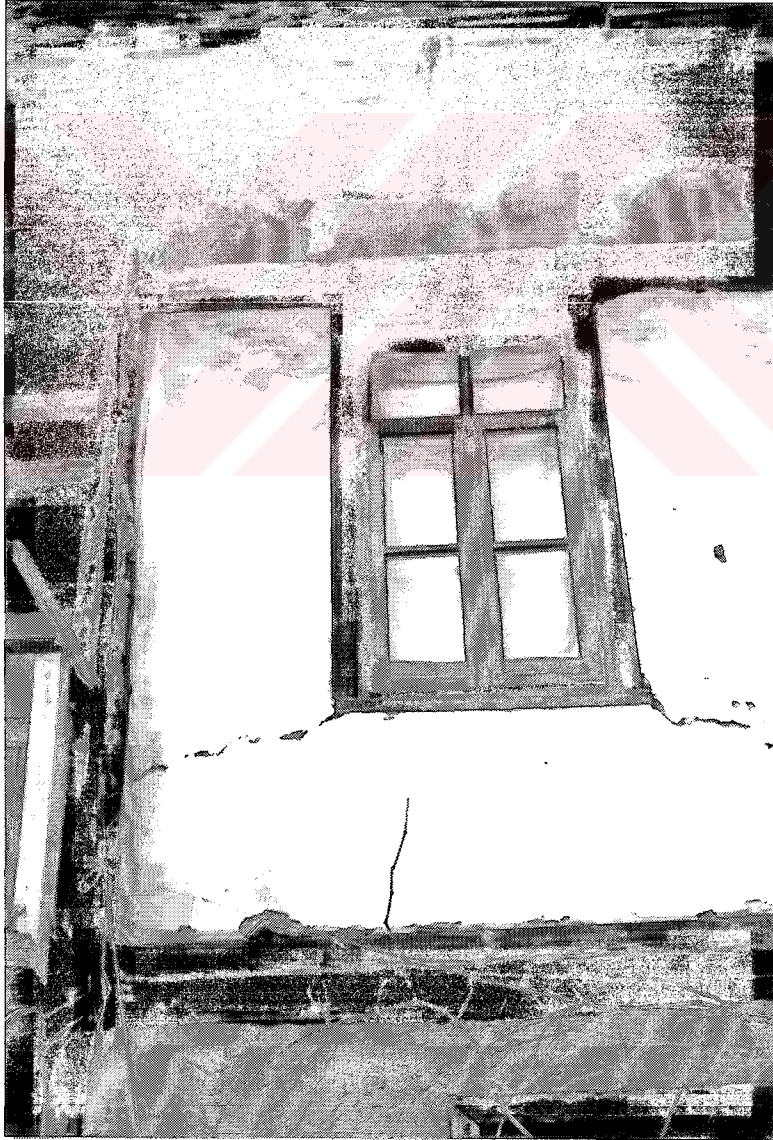
Şekil D.65 Hendek, sıva çatlağı
