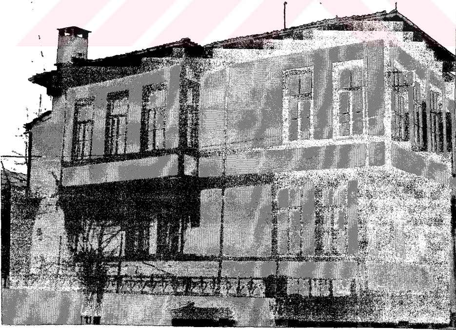
Şekil E.49 Adapazarı, 17 Ağustos 1999 Kocaeli depreminde hasar alan ahşap iskeletli yapılar ( KTBKTVK Bursa Bölge Kurulu arşivi )
