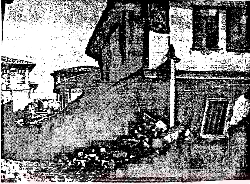
Şekil D.13 Çerkeş 1944, zemin katın yıkılmasının üst yapıya hasar vermesi ( Kafesçioğlu, 1955: 125 )
