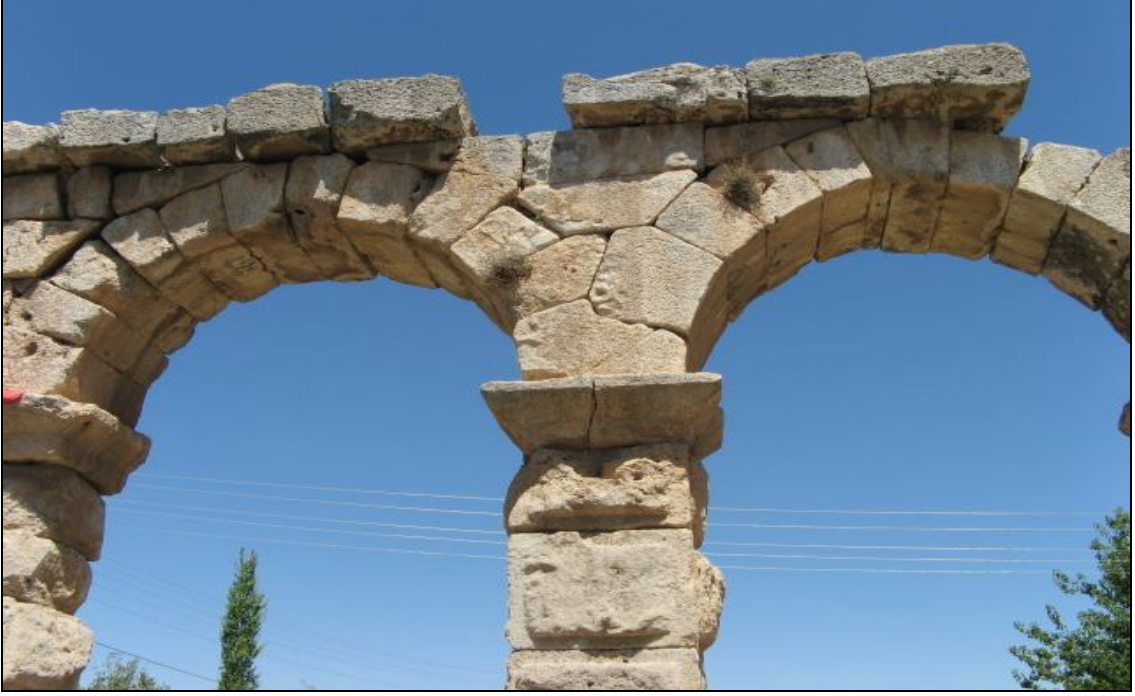
Fotoğraf 3.10 Kemerlerde farklı taş işçiliği ve farklı heterojenlikte malzeme kullanımı ile yersel bozulmaların görünümü
