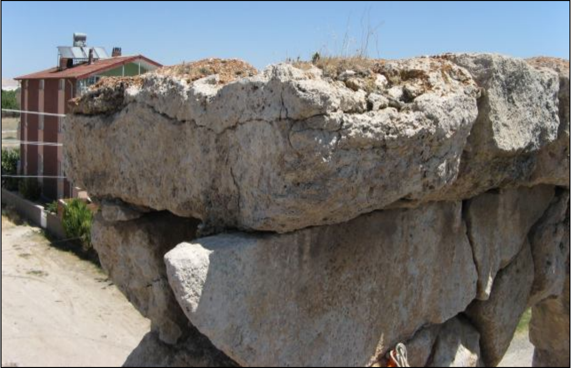
Fotoğraf 3.12 Farklı özelliklerdeki travertenlerin bir arada kullanılması ve kullanım yerindeki sorunlar
