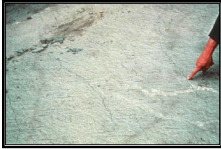
Şekil 60. Isı çatlakları ( Erdal 2005 ).
