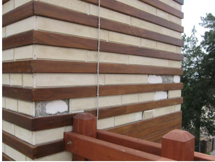
Şekil 106. Taş kaplamanın hasar görmesi, Antalya (Sütiçen arşivinden).
