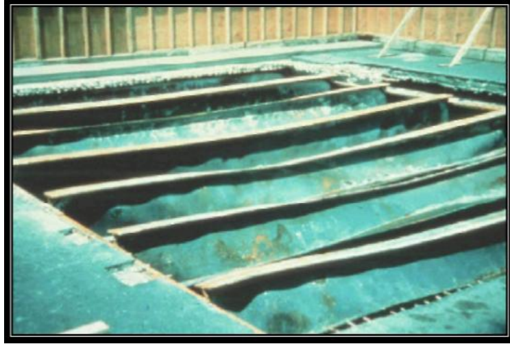
Şekil 83. Aşırı sıcaklık hasarları (Erdal 2005).
