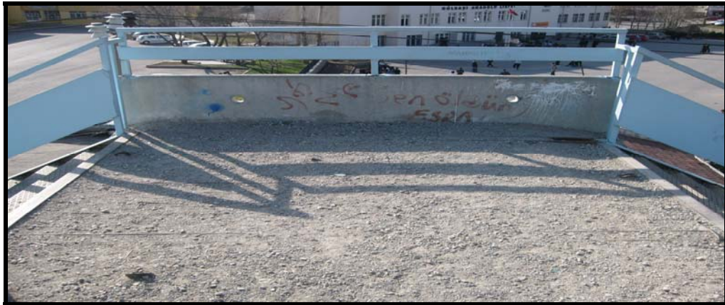
Şekil 71. Kimyasallar sonucu çatlayan beton tabakası. (Sütiçen arşivinden).
