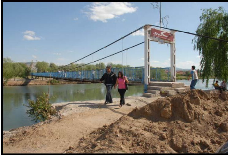
38. Köprü zemin oturum sorunları, düzensiz merdiven, Göreme (Sütiçen arşivinden)
