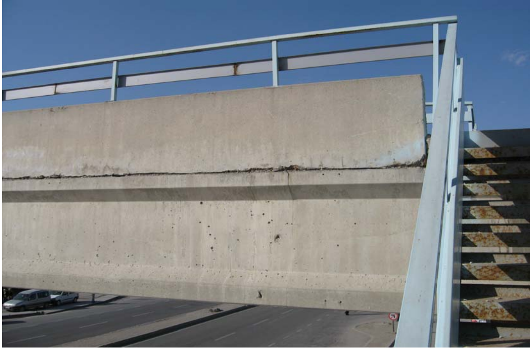
Şekil 73. Dizayn hatasından kaynaklanan betondaki aşınma ( Sütiçen arşivinden ).
