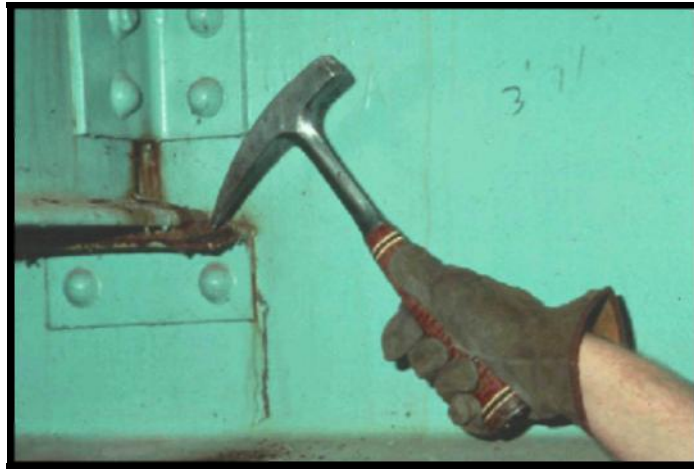
Şekil 89. Korozyon metal yorgunluğu köprü: Bu tür çatlakların görülebileceği belli başlı yerler kontrol edilmelidir (Erdal 2005).
