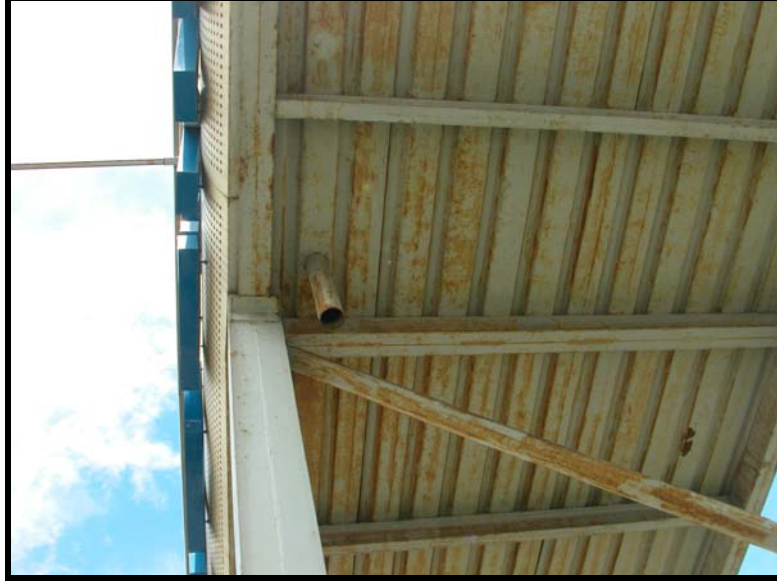
Şekil 104. Köprülerde oluşan yağmur gideri detay sorunları, Antalya (Sütiçen arşivinden).
