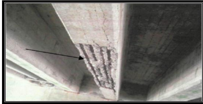
Şekil 55. Kirişte paspayı ve korozyon problemi (Erdal 2005).
