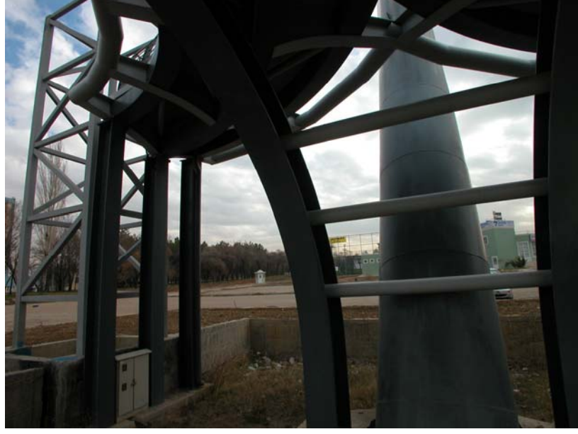
Şekil 100. Elektrik panoları sorunsuz uygulama, Ankara ( Sütiçen arşivinden ).
