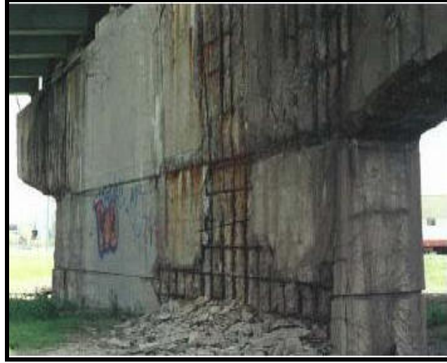
Şekil 67. Betonda korozyon sonucu oluşan çatlaklar (Sokullu,E,1999).
