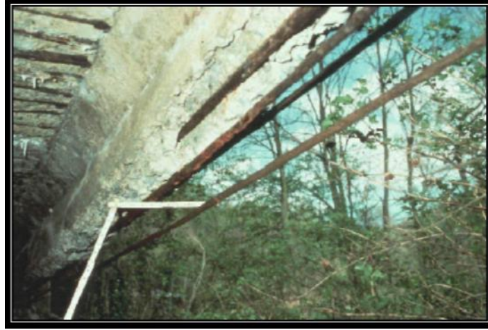
Şekil 68. Donatıda Korozyon (Erdal 2005).
