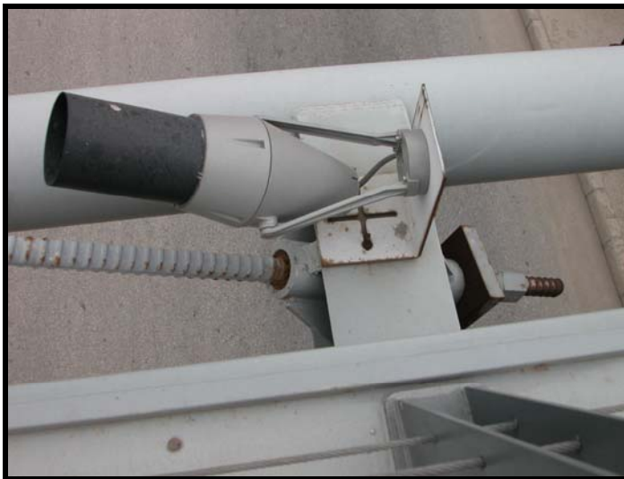
39. Çelik köprülerde korozyon, Antalya (Sütiçen arşivinden).
