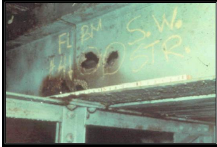
Şekil 74. Korozyon ve kesit kaybı (Erdal 2005).
