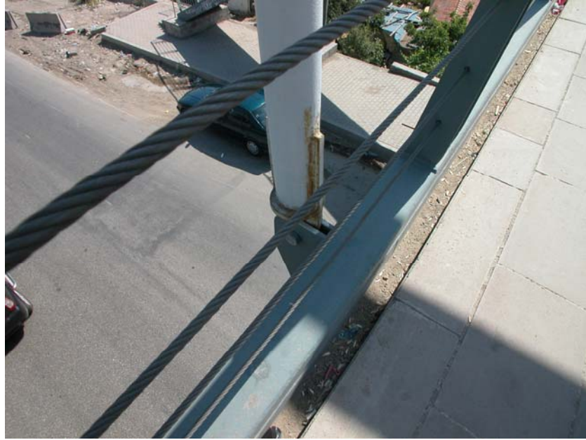
Şekil 75. Ankara yaya üst geçitlerinde taşıyıcı sistem noktalarındaki korozyon) (Sütiçen arşivinden).
