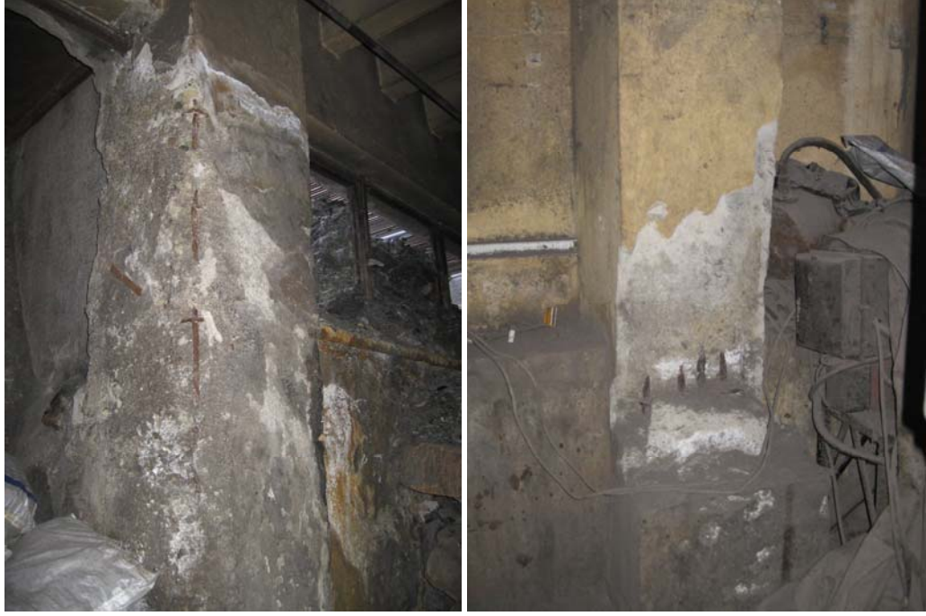
Şekil 3.16 Akşehir Kız Meslek Lisesi bodrum kat kolon ve donatı görüntüsü
