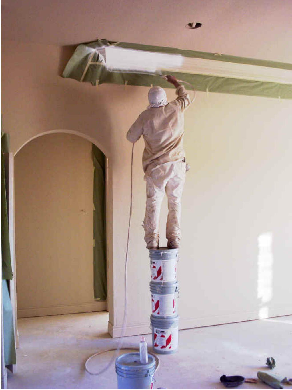
Şekil 1.5. Güvensiz davranış: Uygun olmayan alet kullanımı
