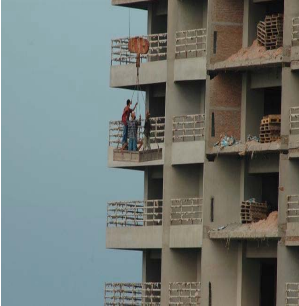
Şekil 1.4. Güvensiz davranış: Uygun olmayan alet kullanımı
