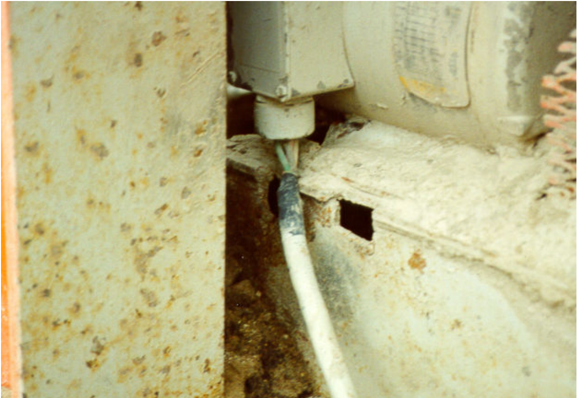
Şekil 1.10. Güvensiz durum: Kontrolleri eksik ekipman
