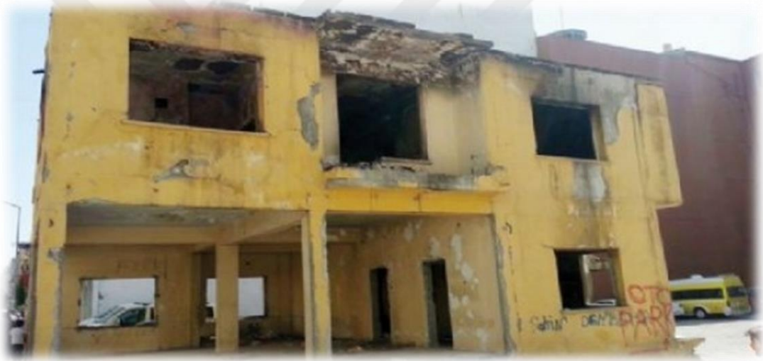
Fotoğraf-15: 6-8 Ekim olaylarında PTT Kargo hizmet binasının yakılmış hali. ( https://www.google.com.tr/search?q=6-8+ekim+olaylar%C4%B1+van&rlz=1C2OKWM_trTR800TR800&source=lnms&tbm=isch&sa=X&ved=0ahUKEwWij6vbfw8rdAhXMFSwKHZb6CwQAUICigB&biw=1366&bih=657#imgdii=gUCIPU9mhwLAGM:&imgsrc=Aekzmc7u600W0M ). (E.T: 21.09.2018).
